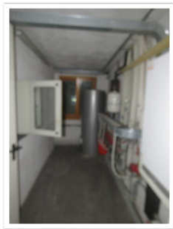
Piano interrato: centrale termica e particolare dei muri perimetrali/finestre.
