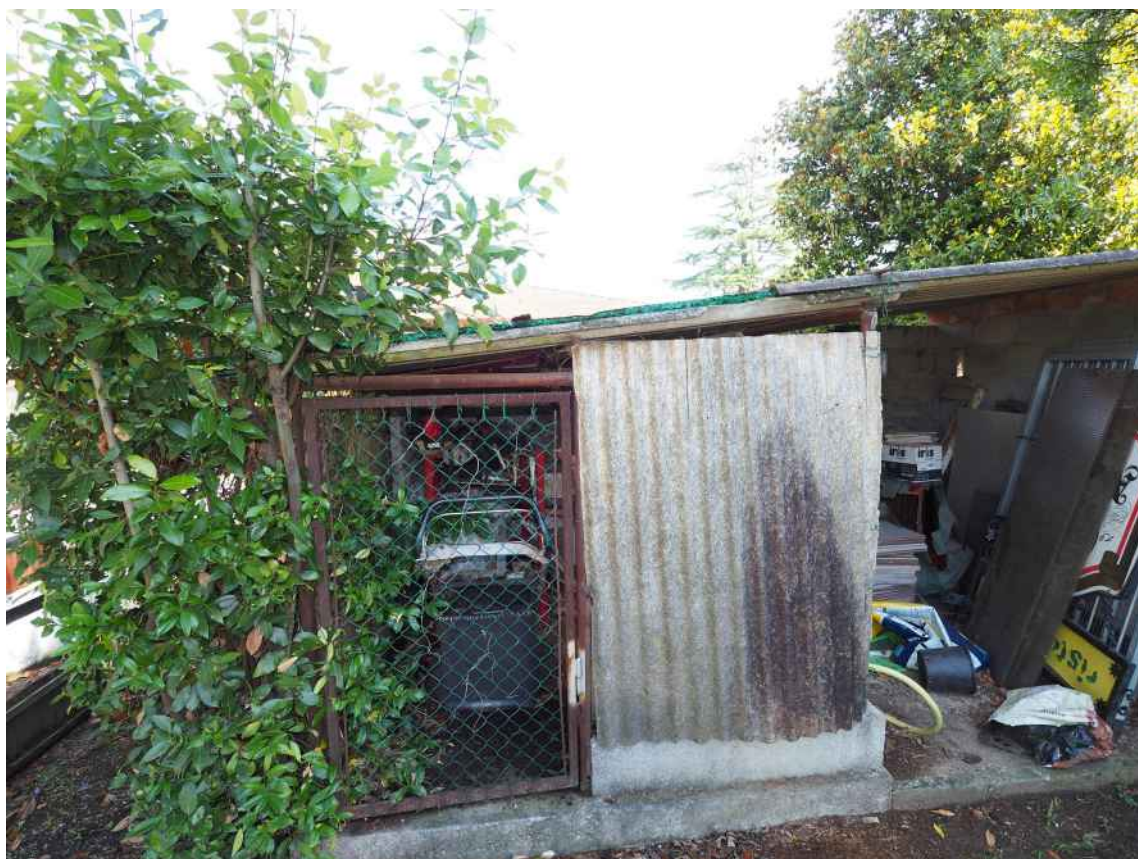
Porcia, via della Centa n. 3 - NCT al foglio 10, part. 429 – Il manufatto abusivo.
