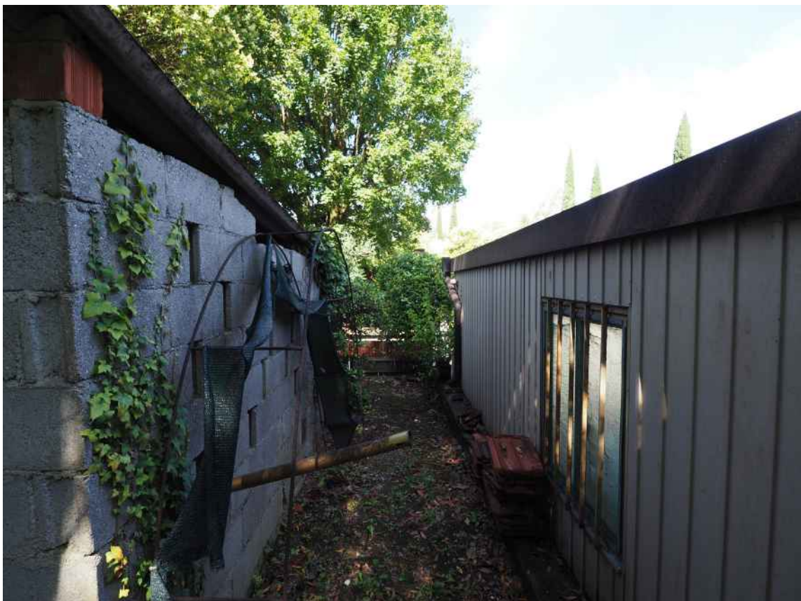
Porcia, via della Centa n. 3 - NCT al foglio 10, part. 429 – Il manufatto abusivo .
