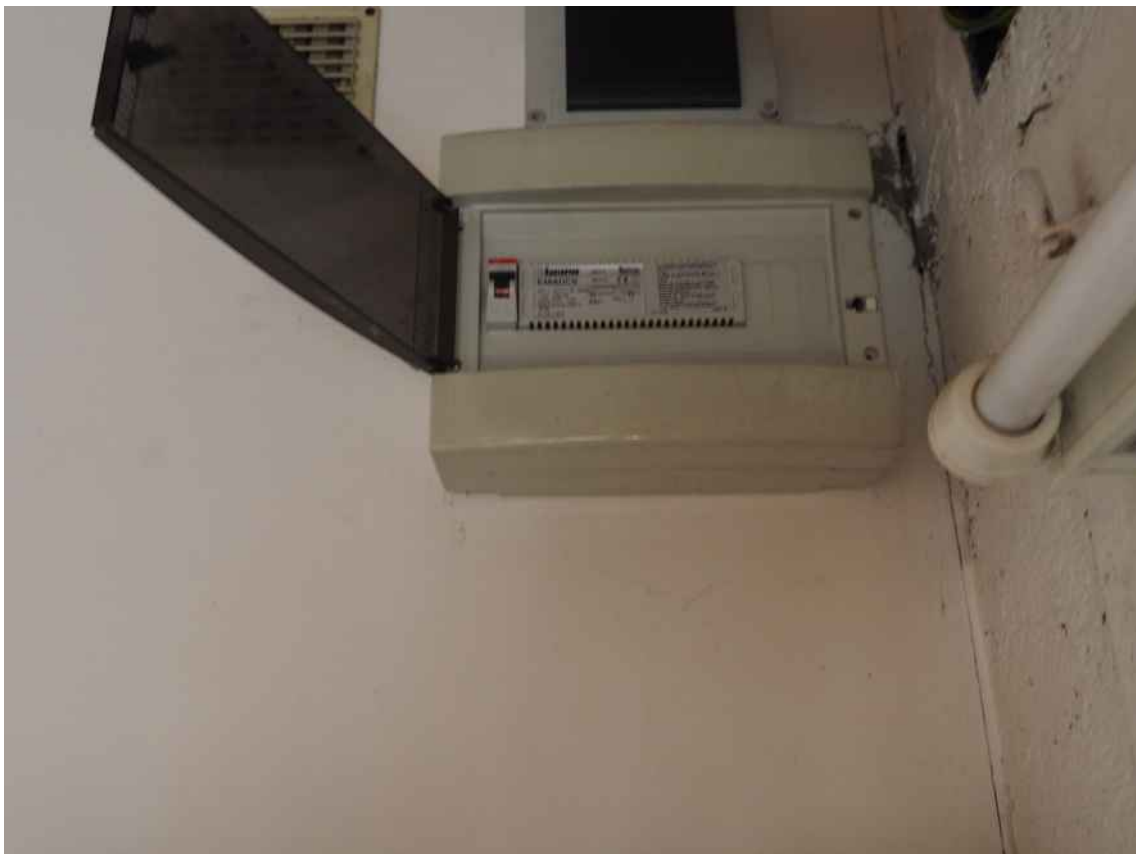
Porcia, via della Centa n. 3 – Sopra particolari degli interruttori e delle placchette, sotto un quadro elettrico ubicato nella soffitta.
