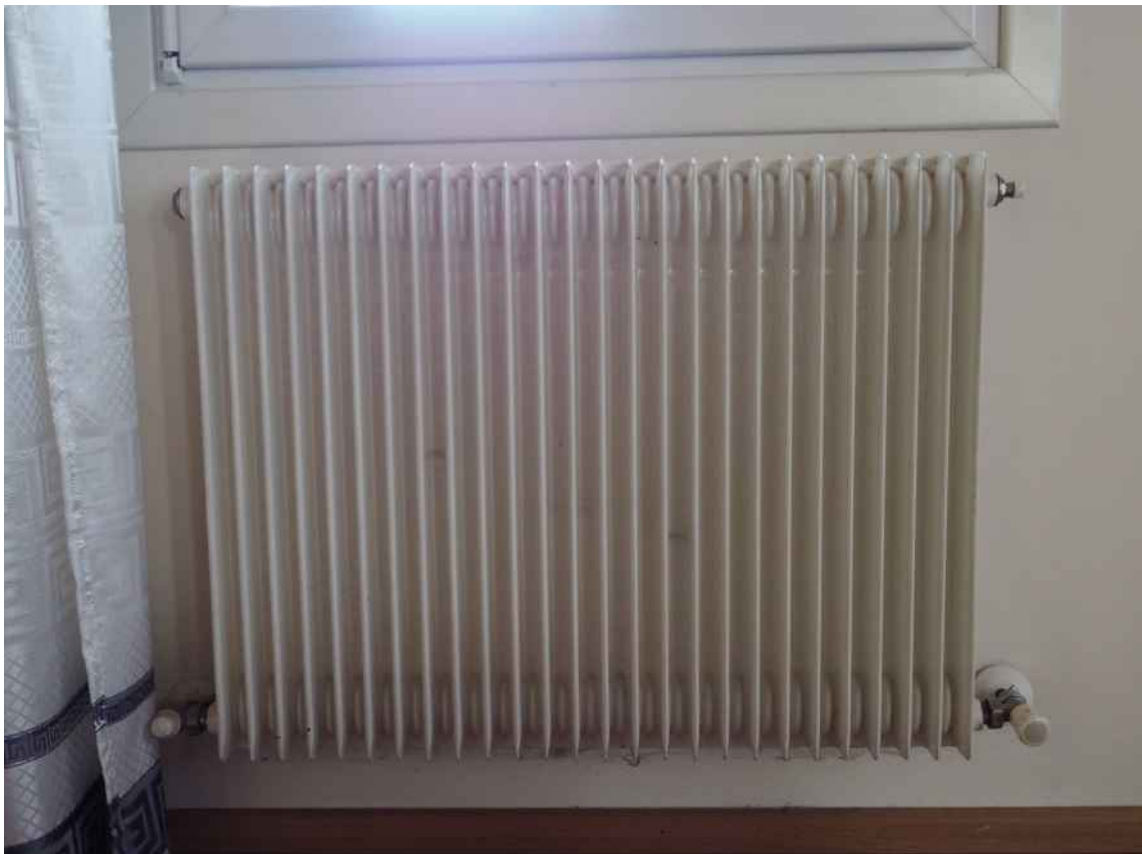
Porcia, via della Centa n. 3 – Il condizionatore ed il radiatore nel vano pranzo soggiorno.
