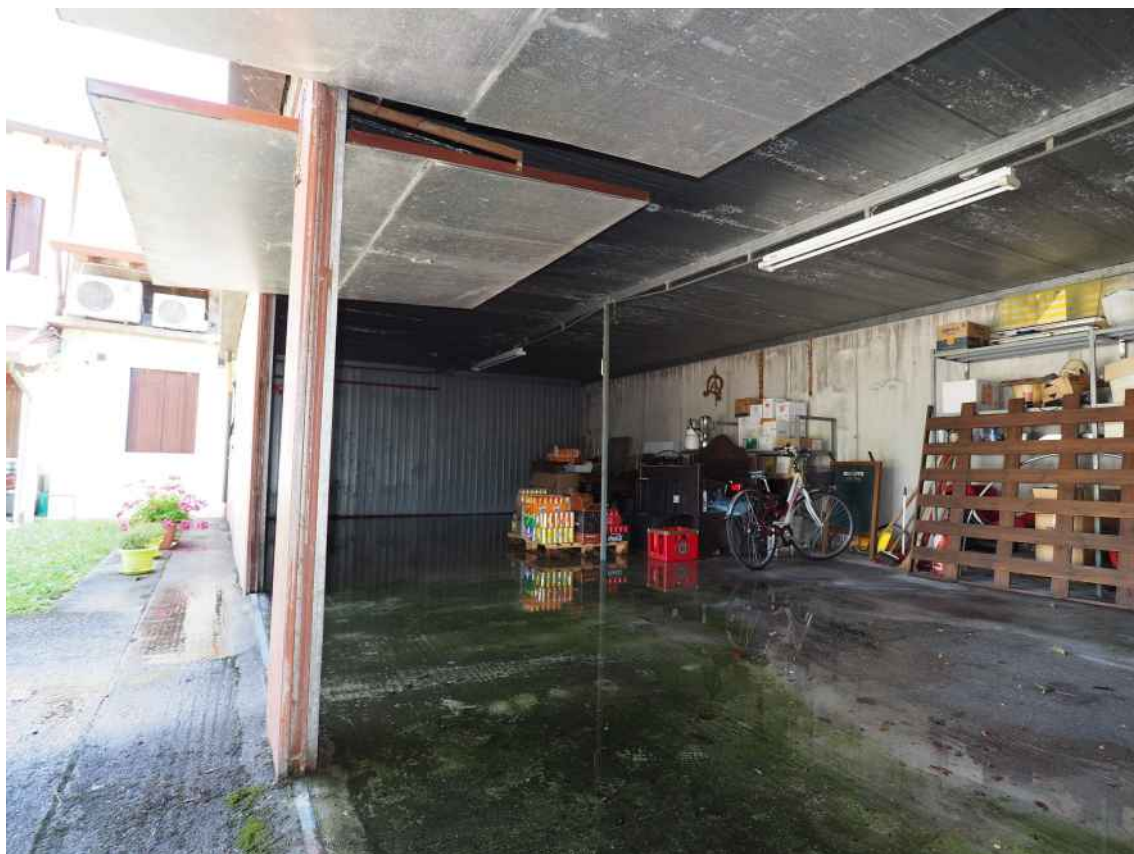
Porcia, via della Centa n. 3 - NCEU foglio 10, part. 19, sub. 11 – Il garage allagato dalle piogge.
