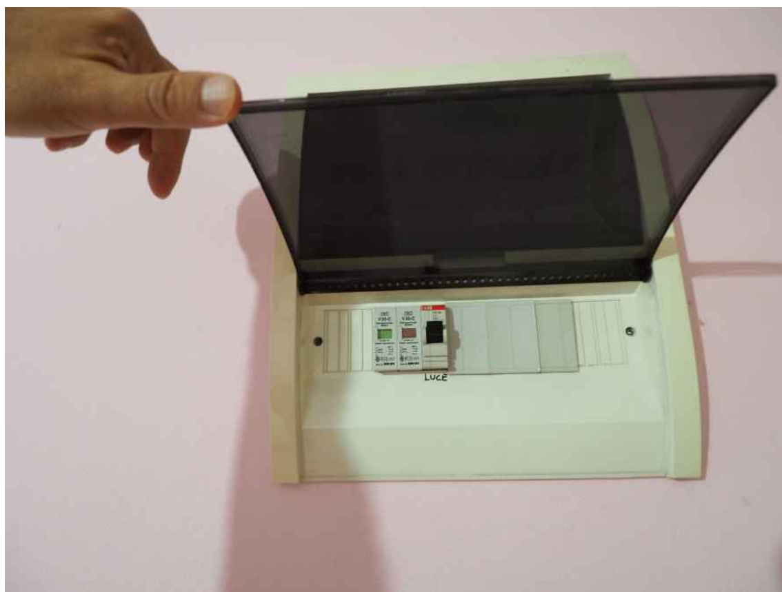
Porcia, via della Centa n. 3 – Due quadri elettrici ubicati nella camera 1.
