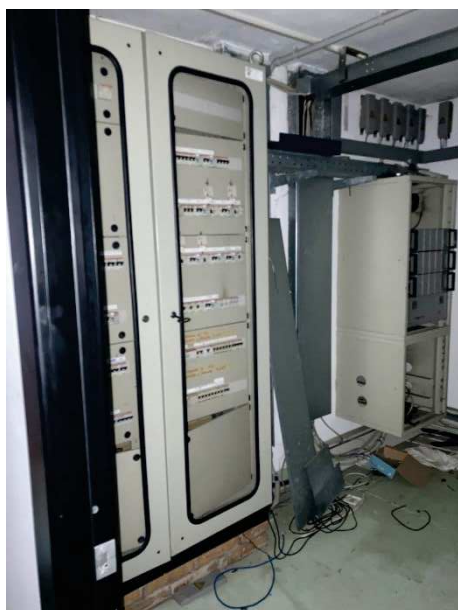
vista ripostiglio quadri elettrici al piano seminterrato
