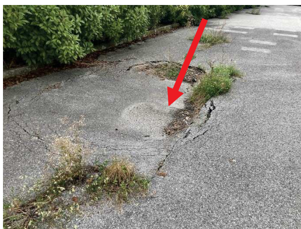
particolare degrado piazzale lato Ovest
