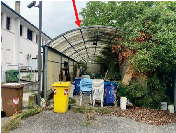
ulteriore particolare della tettoia abusiva lato Sud
