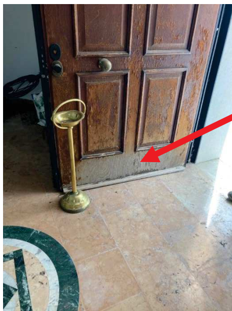
particolare degrado della porta d'ingresso nel vano scala a sud quale bene comune non censibile sub. 8
