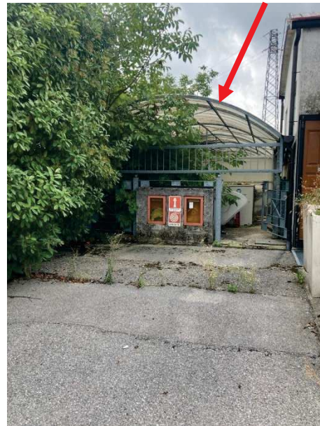
ulteriore particolare della tettoia abusiva lato Nord
