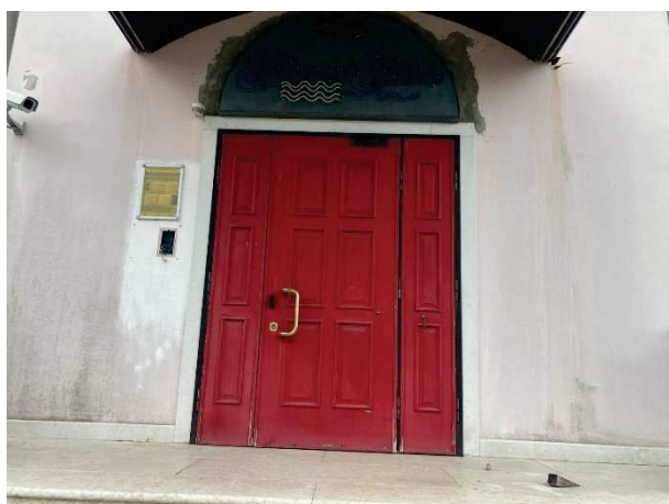
particolare degrado porta d'ingresso nel locale "night club" al piano rialzato lato Nord
