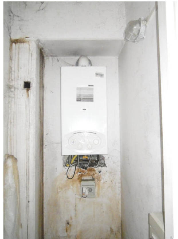
vista del vano caldaia
