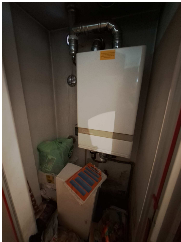
Foto n. 11: vista della caldaia
