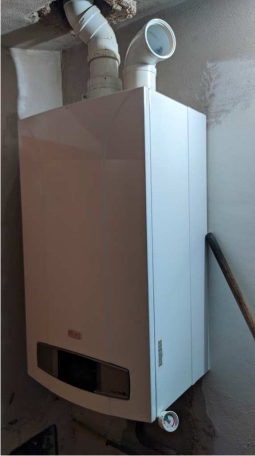
Locale tecnico con la caldaia (la caldaia è utilizzata anche dell'appartamento al piano 2)
