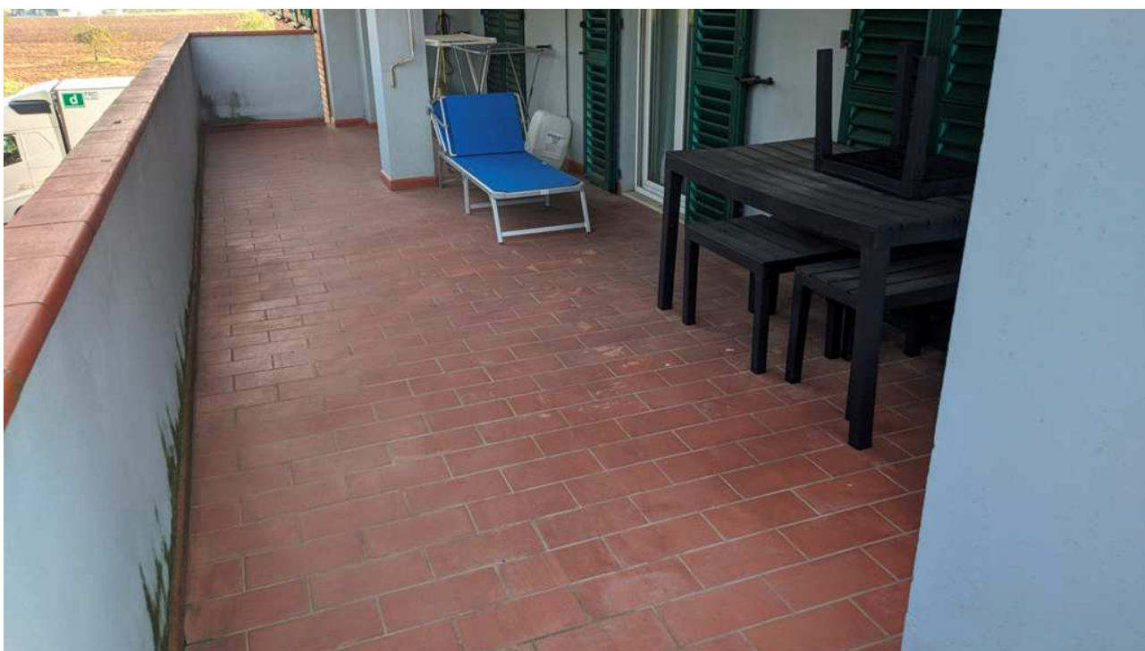
Balcone perimetrale con pilastri e tracce di muffe ed umidità nei parapetti
