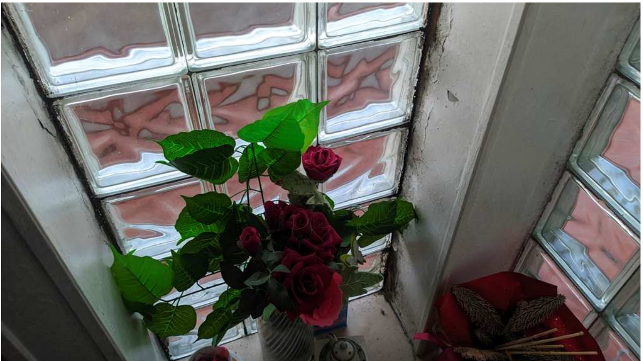
pareti in vetrocemento (dettaglio stato conservazione)
