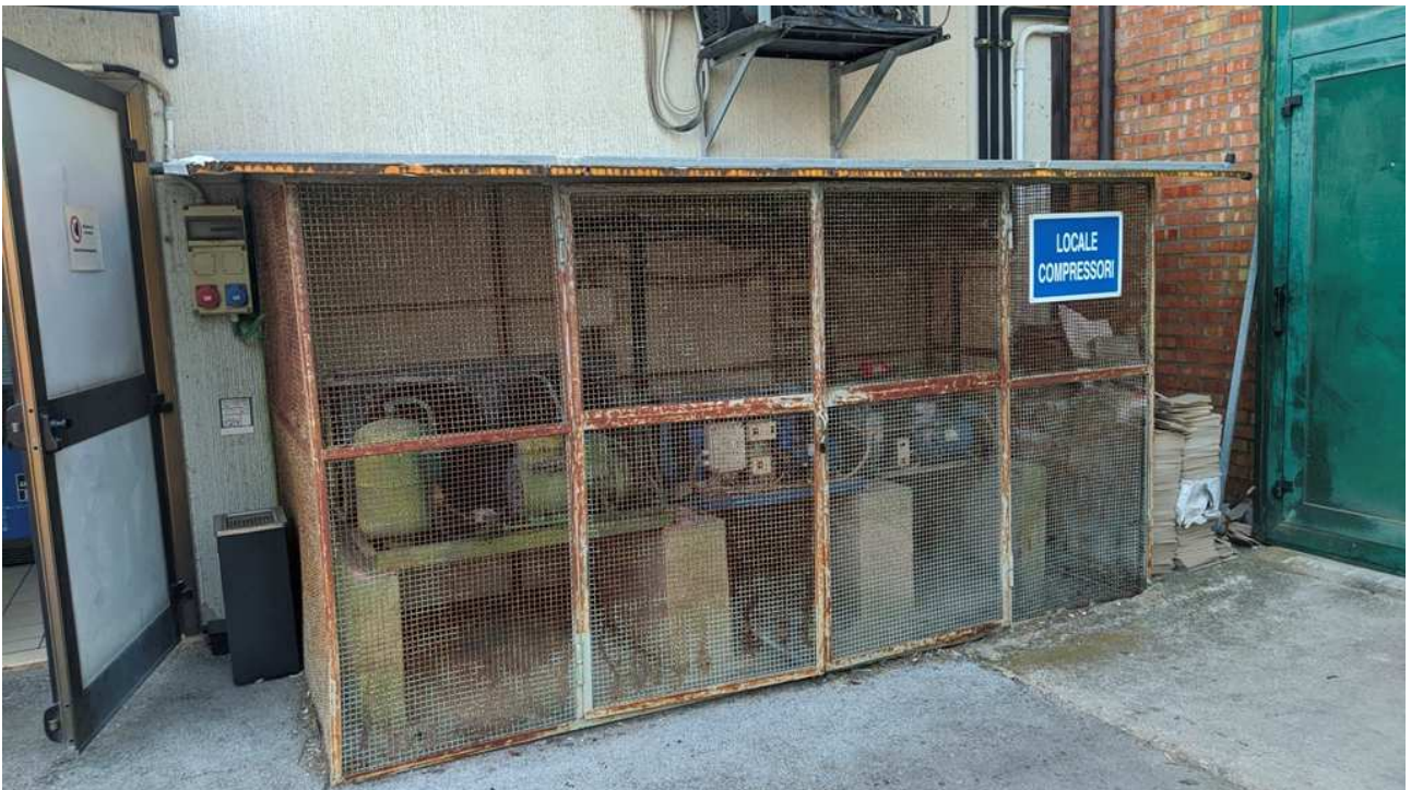
Dettaglio compressori esterni all'edificio, a servizio dell'attività
