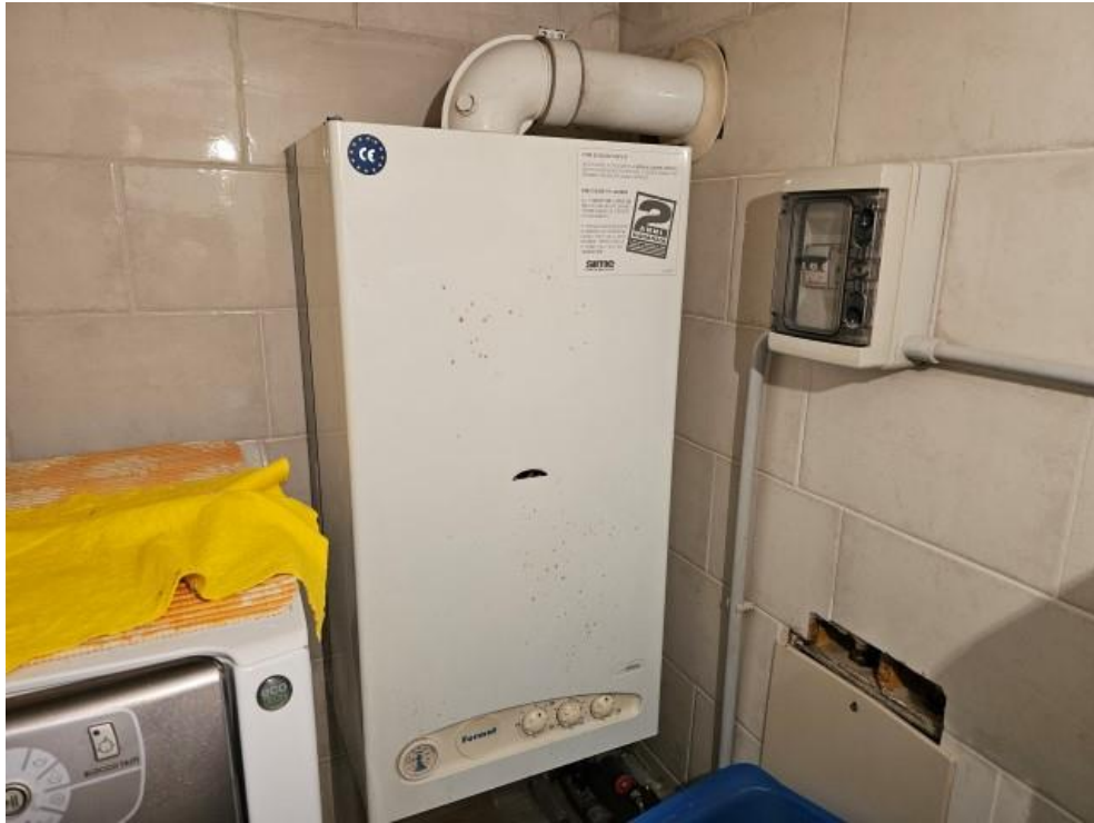
FOTO 19: CALDAIA (SUB. 4 – 1°P.)
