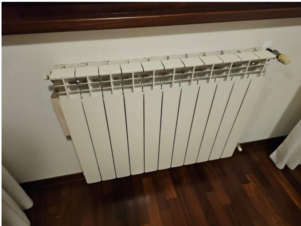
FOTO 20: PARTICOLARE RADIATORE (SUB. 4 – 1°P.)
