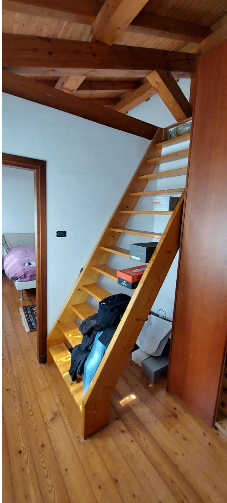
Difformità scala su vano guardaroba
