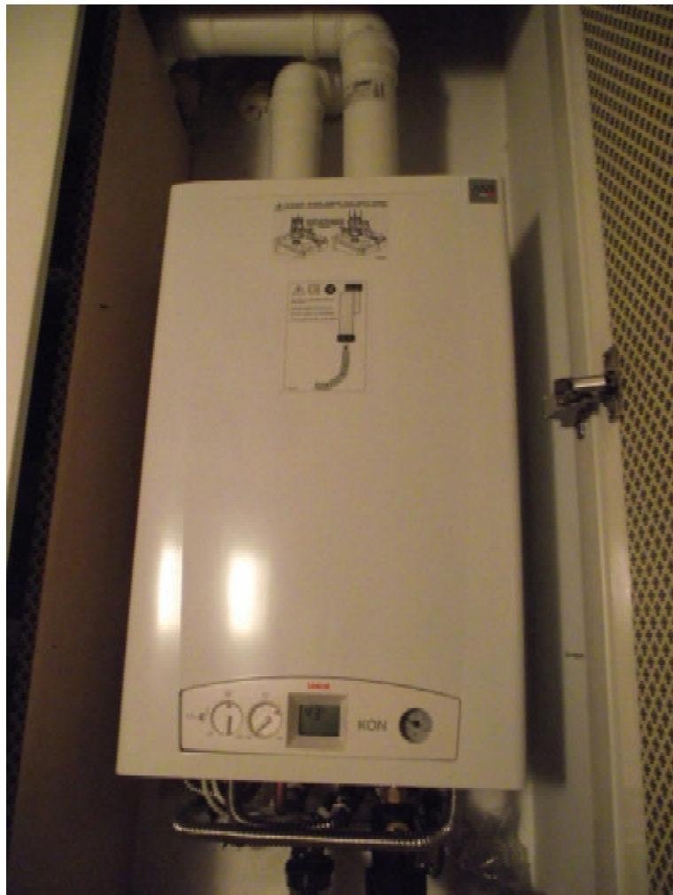
Foto 10 – Caldaia autonoma posizionata entro nicchi su altra proprietà (abusiva)
