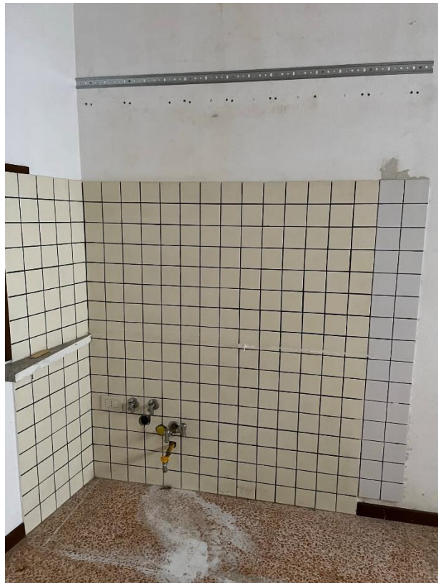
Dettaglio degli attacchi idrici del locale posteriore
