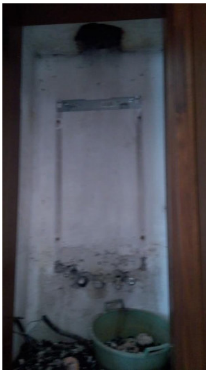
Impianto caldaia a gas (rimossa)
