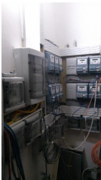
Vano contatori elettrici (Piano seminterrato)
