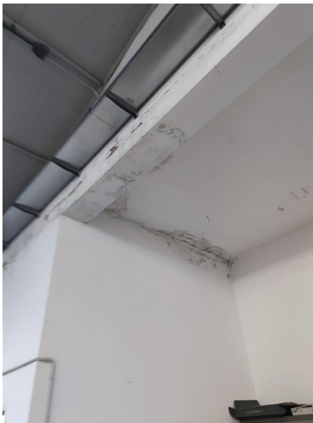
Foto alleg. n°20 - Danni da infiltrazioni immobile sottostante
