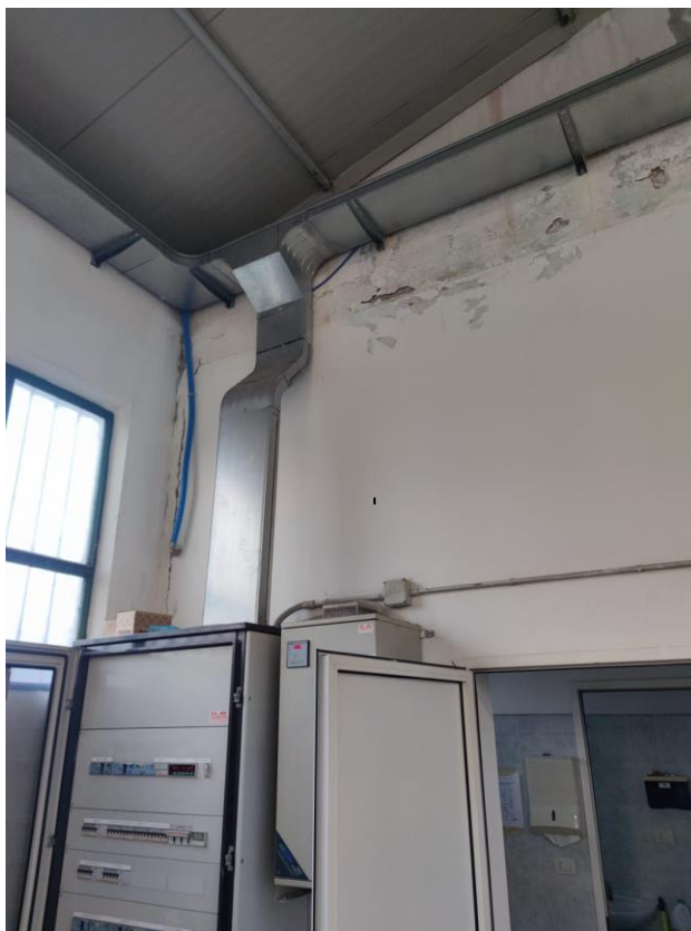
Foto alleg. n°19 – Danni da infiltrazioni immobile sottostante
