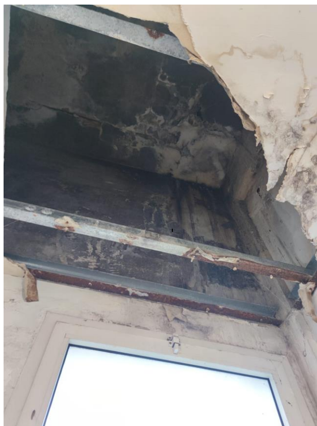
Foto alleg. n°21 - Danni da infiltrazioni immobile sottostante
