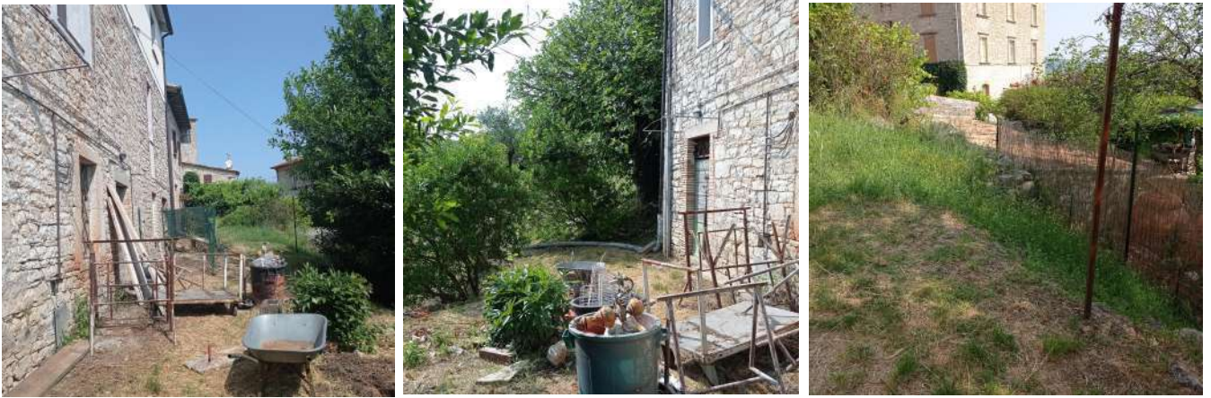
Foto n. 14-16: vista della corte comune - lavori non ultimati e recinzione verso le altre proprietà.
