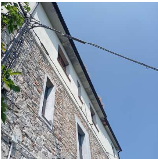
Foto n. 19: dettaglio della trasanna di copertura - infiltrazioni di acqua; - canale di gronda con vegetazione all'interno.
