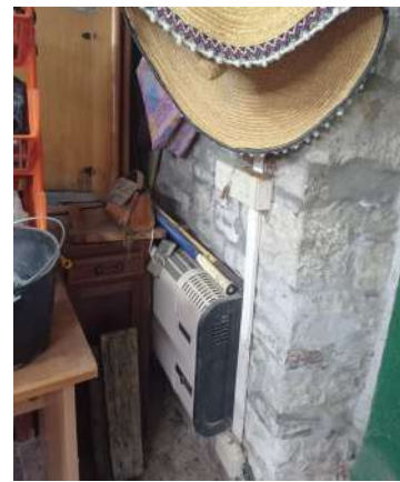
Foto n. 67: dettaglio del ventilconvettore.
