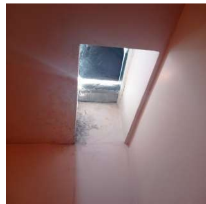
Foto n. 54: dettaglio del lucernario/accesso alla copertura piana. Problemi di infiltrazioni d'acqua
