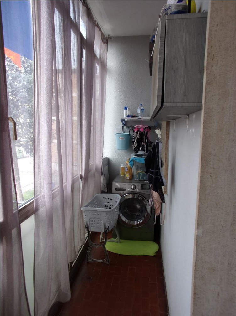
Foto 18: balcone verandato da ripristinare a balcone
