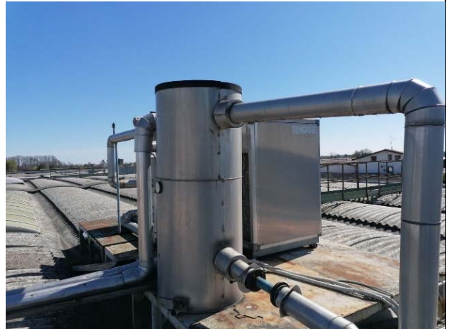
Vista macchine impianti in copertura
