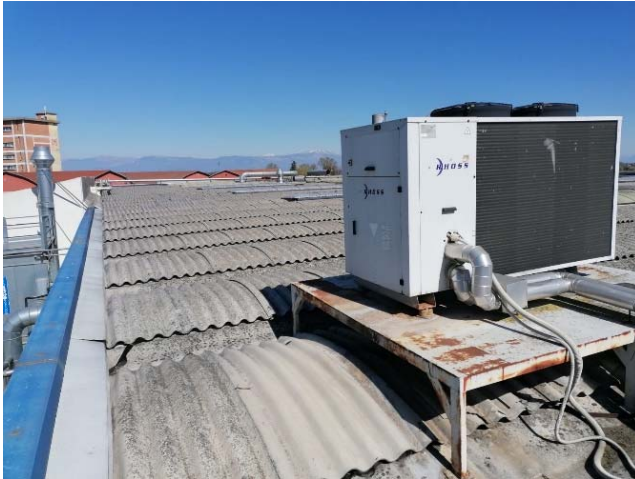
Vista macchine impianti in copertura
