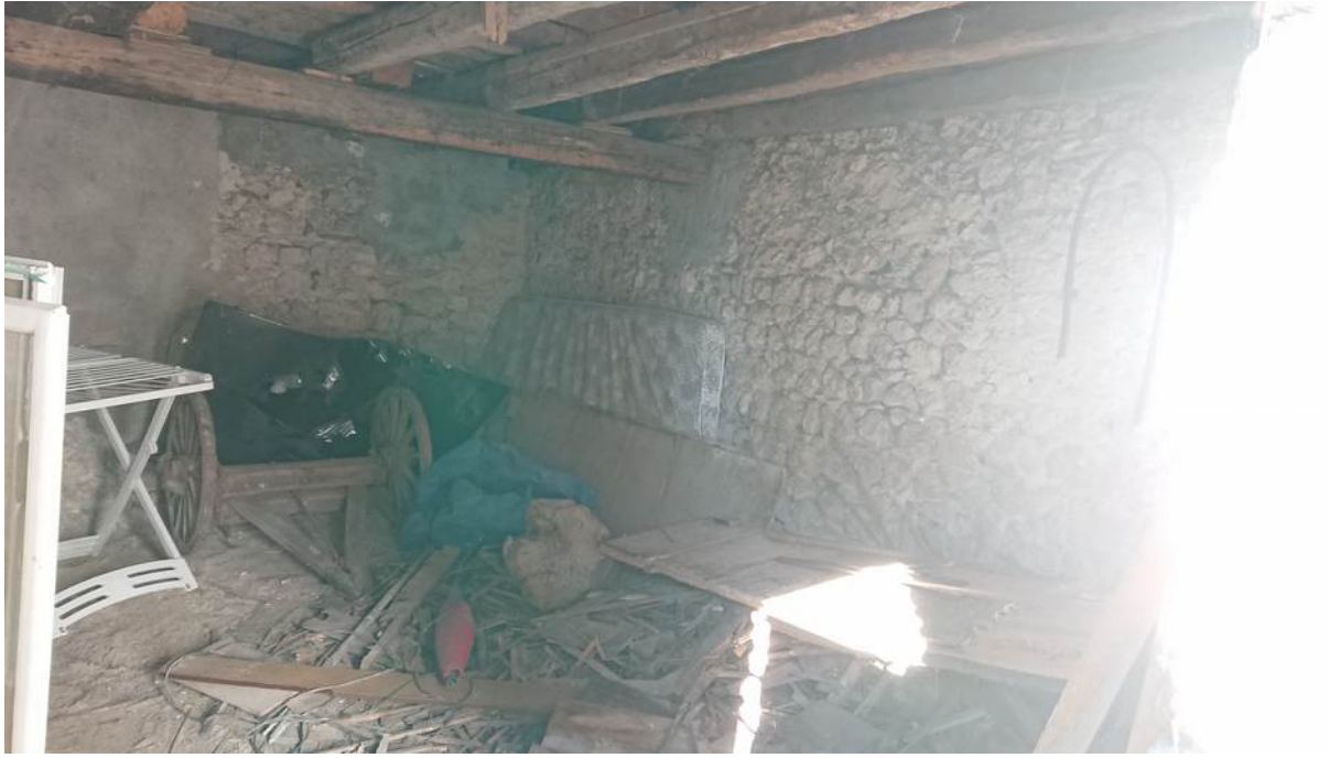
Foto n° 25 - 18/01/2022 - Comune di Caneva, foglio 21, part.159 – Piano terra.
