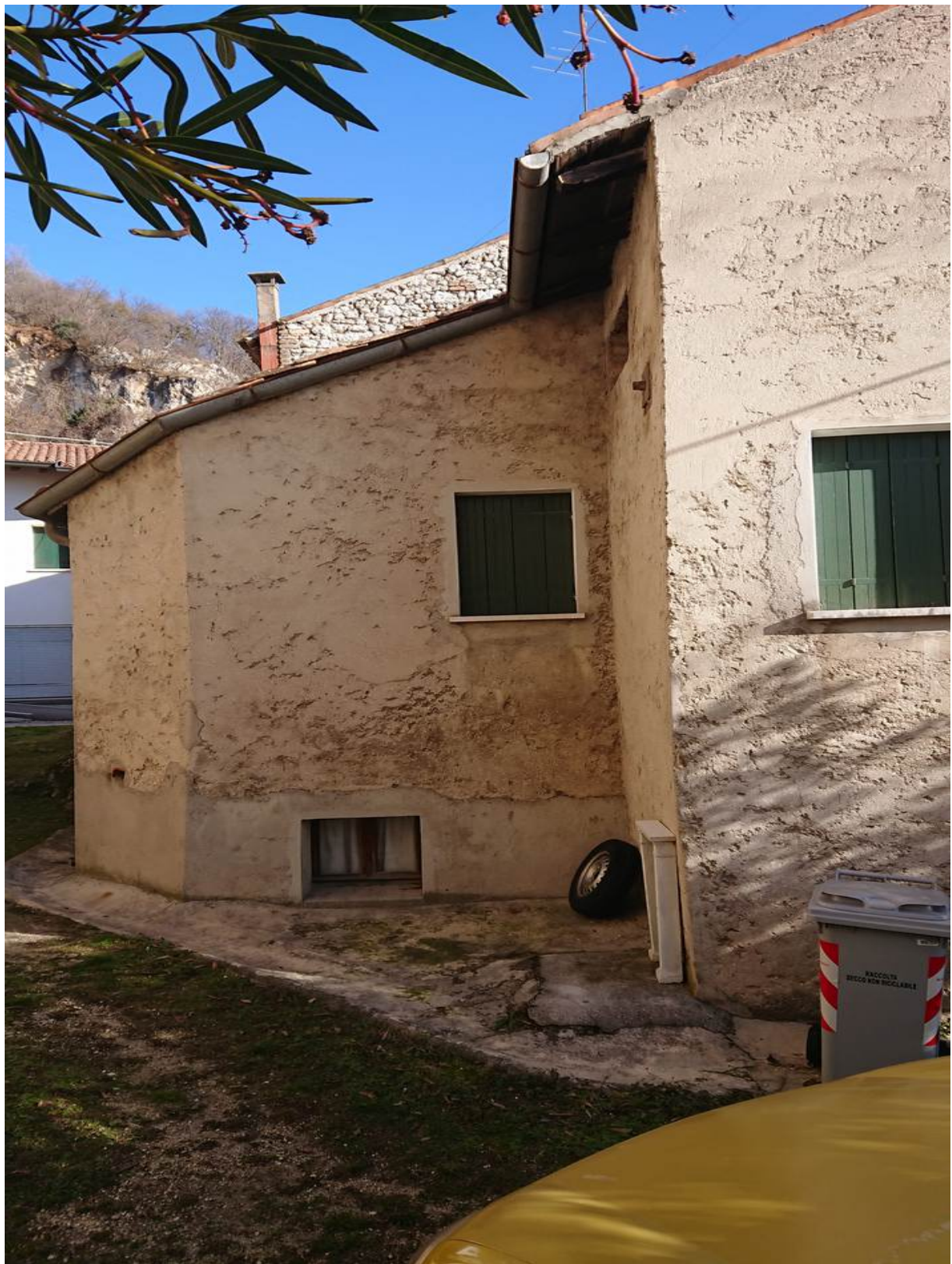
Foto n° 22 - 18/01/2022 - Comune di Caneva, foglio 21, part.156-157 – Esterno dell'abitazione, parete ovest.
