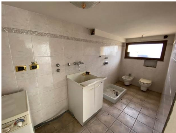
vista bagno/lavanderia da regolarizzare con permesso di costruire in sanatoria
