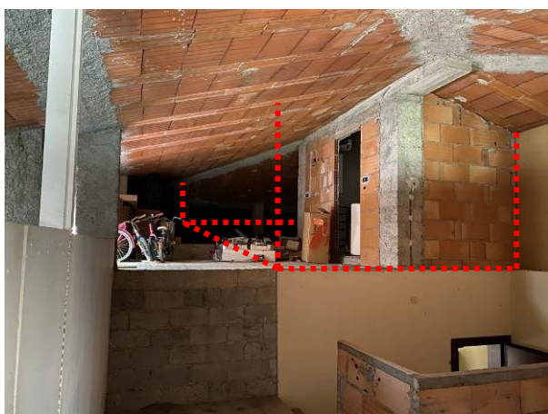
soffitta "in possesso" all'appartamento con altezza media di ml 1.35 da regolarizzare con permesso di costruire in sanatoria
