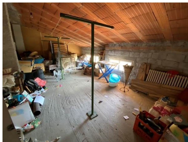
soffitta "in possesso" all'appartamento con altezza media di ml 2.35 da regolarizzare con permesso di costruire in sanatoria
