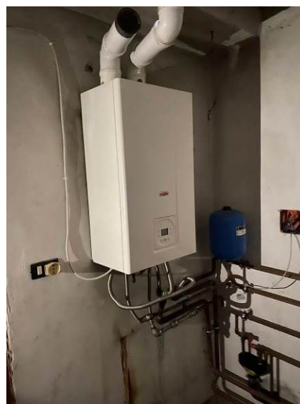
particolare caldaia posta in soffitta "in possesso" all'appartamento da regolarizzare con permesso di costruire in sanatoria
