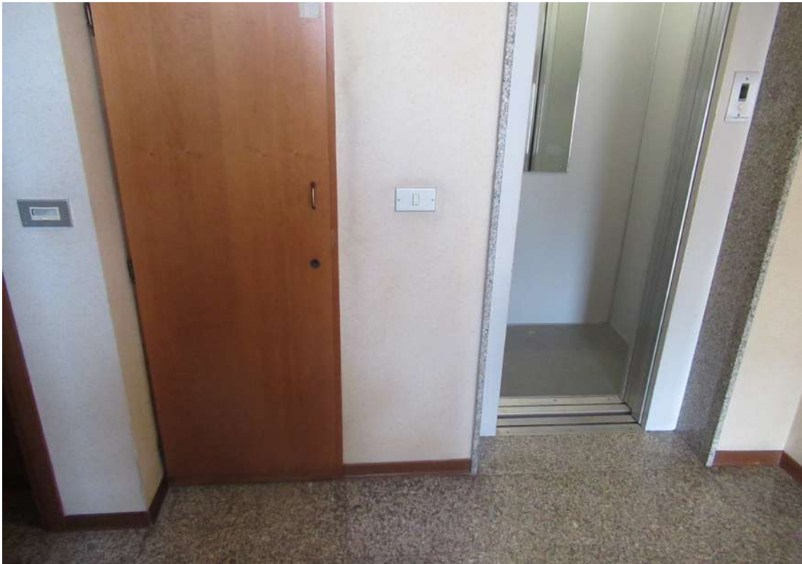
Foto 19: Ascensore con a sinistra vano tecnico impianti tecnologici
