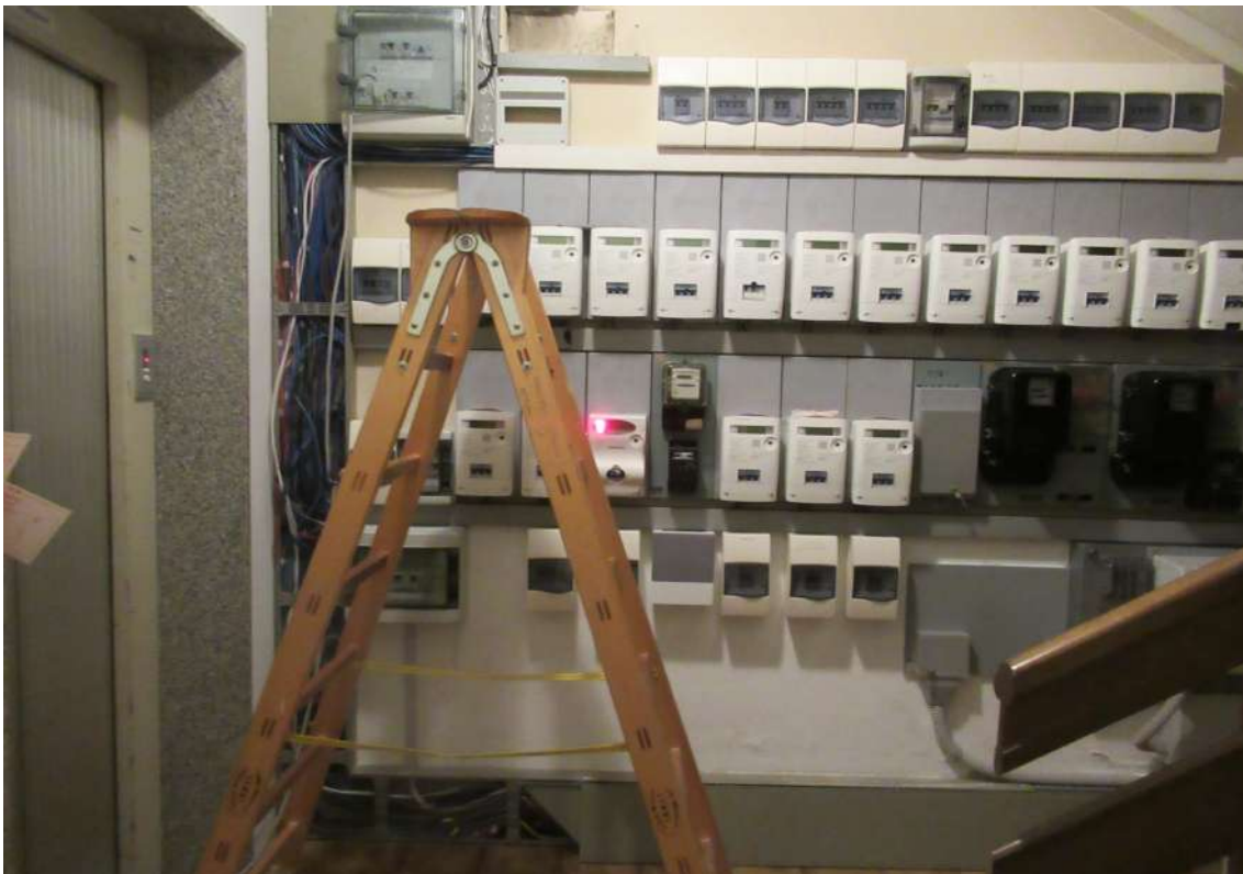
Foto 20: Contatori energia elettrica situati nell'interrato del vano scale
