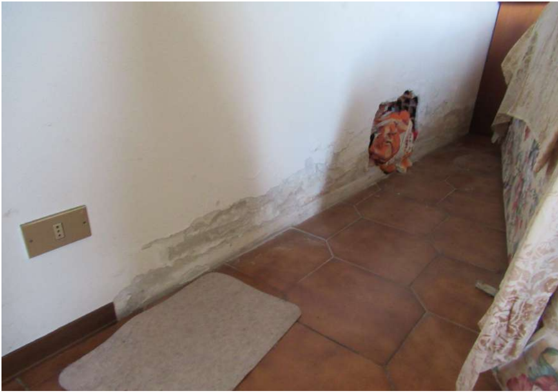
Foto 9: Infiltrazione riparata nella parete soggiorno bagno
