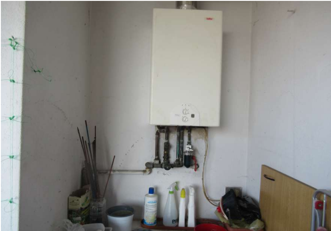
Foto 15: Caldaia sul terrazzo
