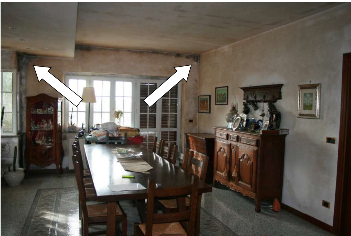
Salone p.1 porzione p.IIIa 232 sub.3: si può notare l'intonaco con segni di umidità e muffa
