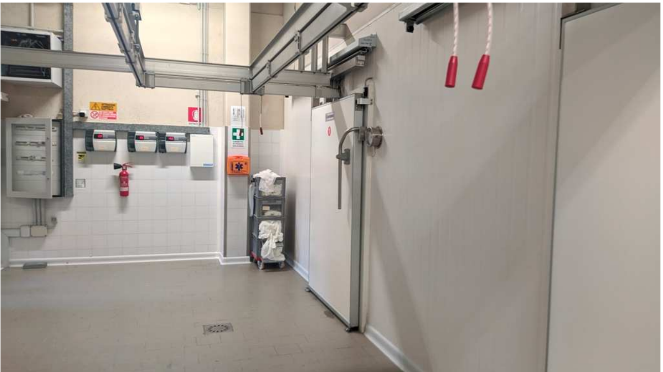
Zona laboratorio con celle frigorifere
