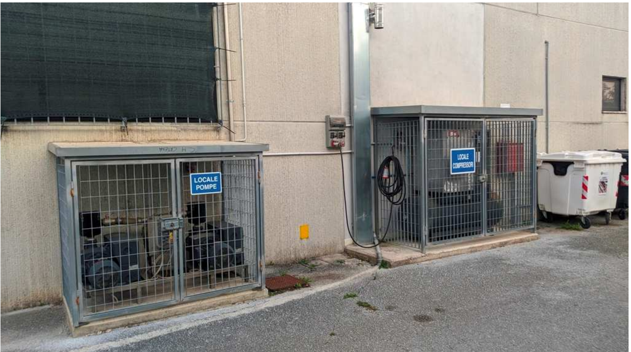
Dettaglio pompe e compressori esterni all'edificio, a servizio dell'attività
