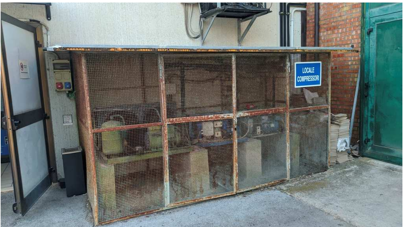
Dettaglio compressori esterni all'edificio, a servizio dell'attività
