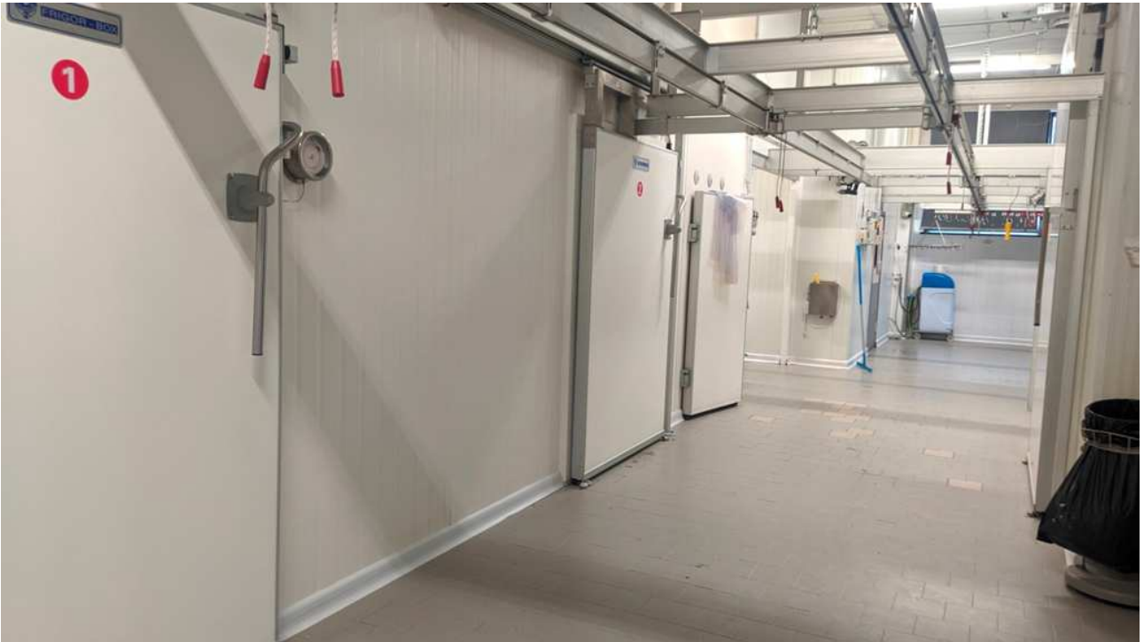
Zona laboratorio con celle frigorifere
