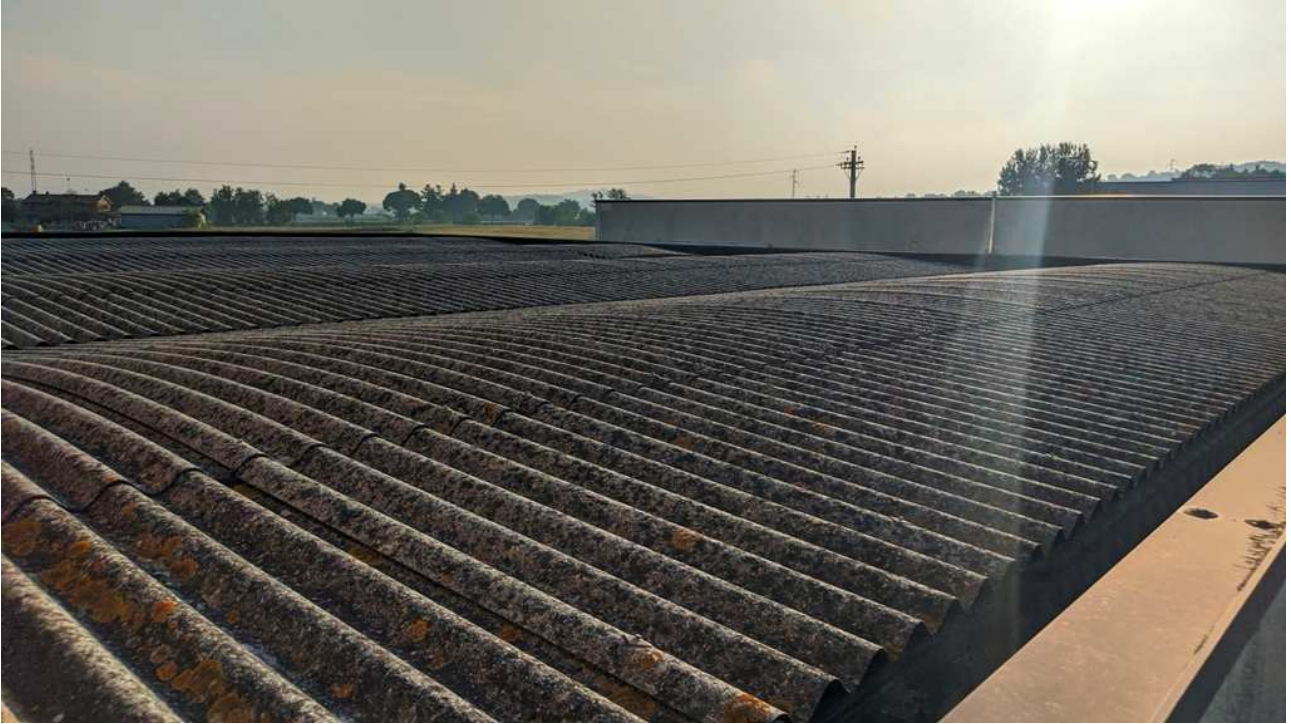
Copertura del capannone, destinato a laboratorio e magazzino, immagine scattata dall'adiacente abitazione
