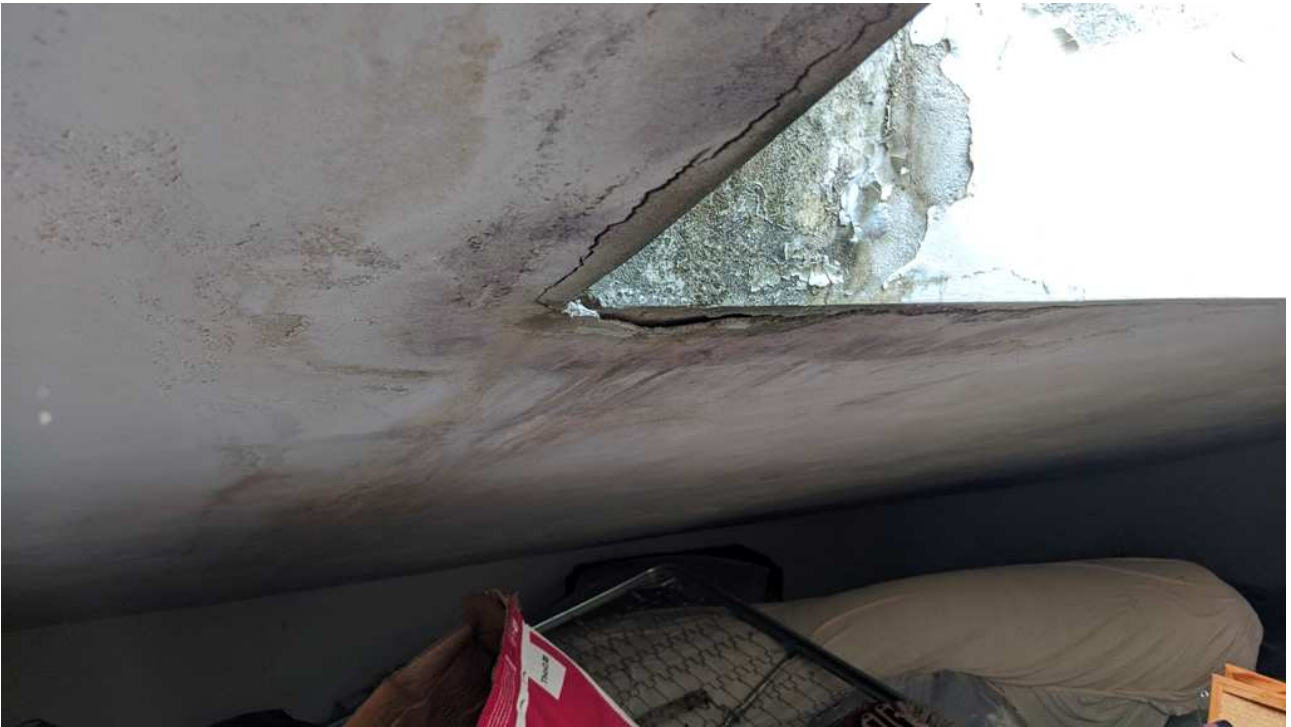
Finestre a tetto, tipologia velux, dettaglio stato conservativo
