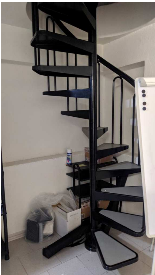
Scala a chiocciola interna che collega i locali a piano terra con i locali destinati ad uffici al piano primo.
