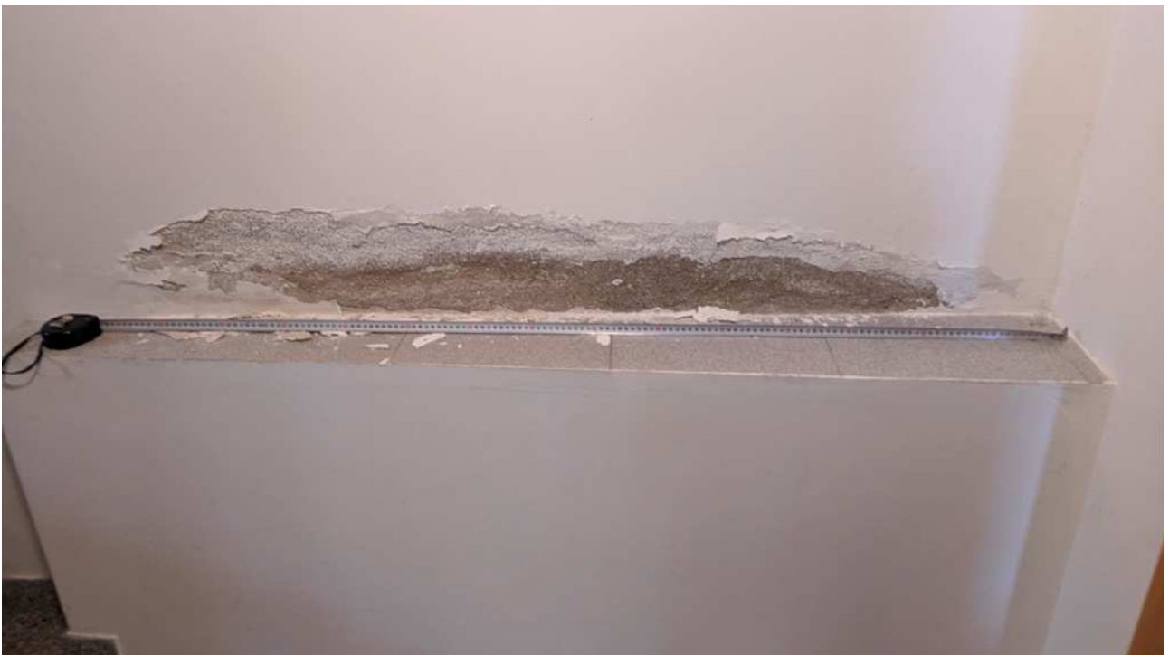
Problemi di infiltrazioni a piano terra in corrispondenza della parete verso il laboratorio artigianale
