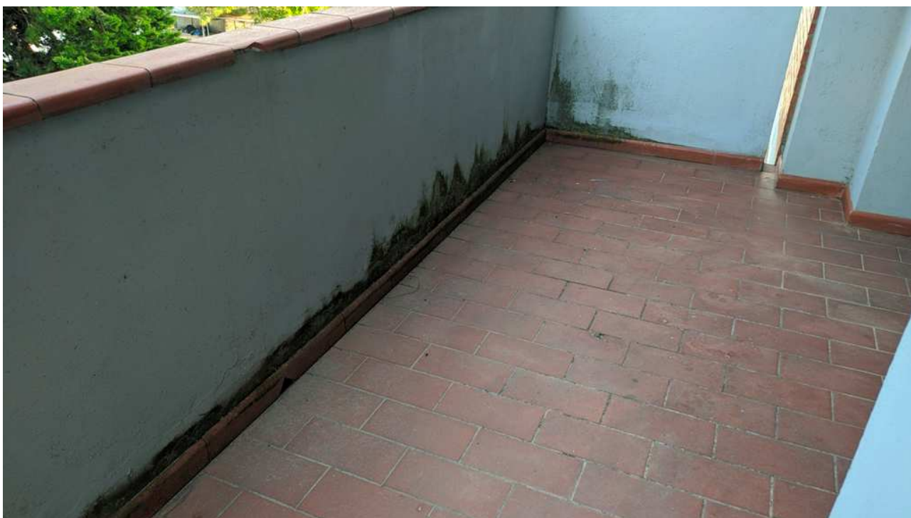
Balcone perimetrale tracce di muffe ed umidità di risalita nei parapetti
