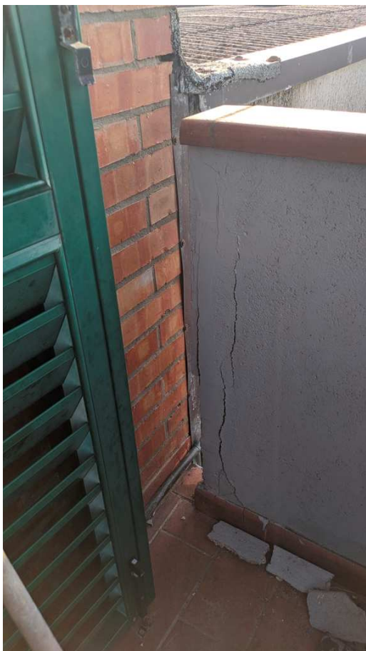
UFFICI, balcone perimetrale , infissi, distacchi nei parapetti, affaccio sulla copertura in lastre di eternit dell'adiacente capannone artigianale
