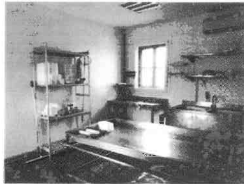
vista laboratorio e impianti 2
