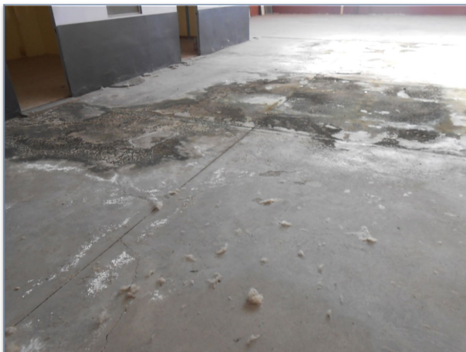
Foto 22 infiltrazioni dalle finestre aperte sulla copertura
