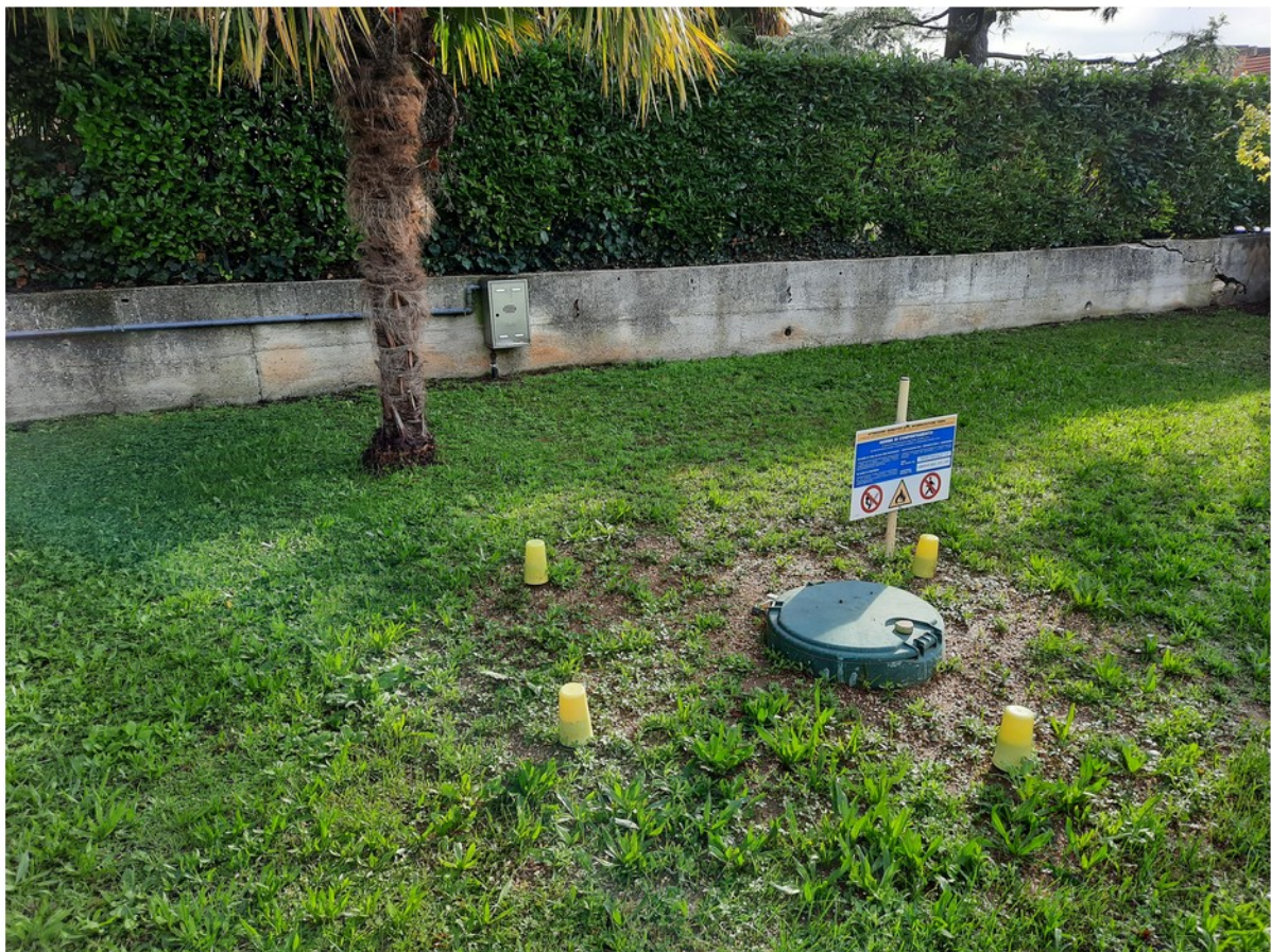
18 - serbatoio gas gpl
