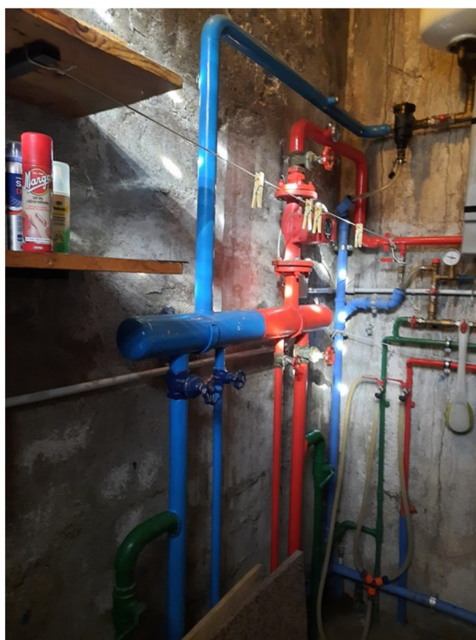
16A - centrale termica
