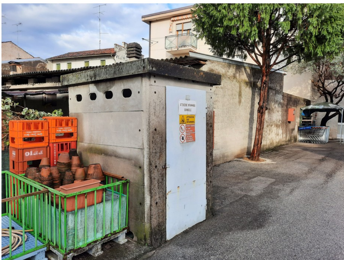
8 - esterno deposito gas
