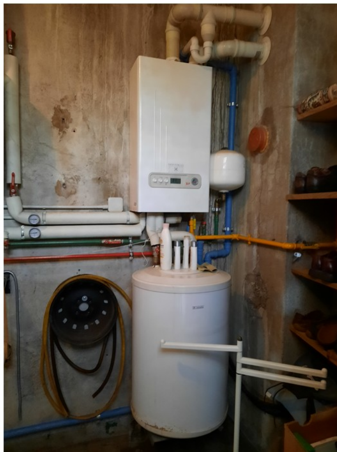
15A - centrale termica
