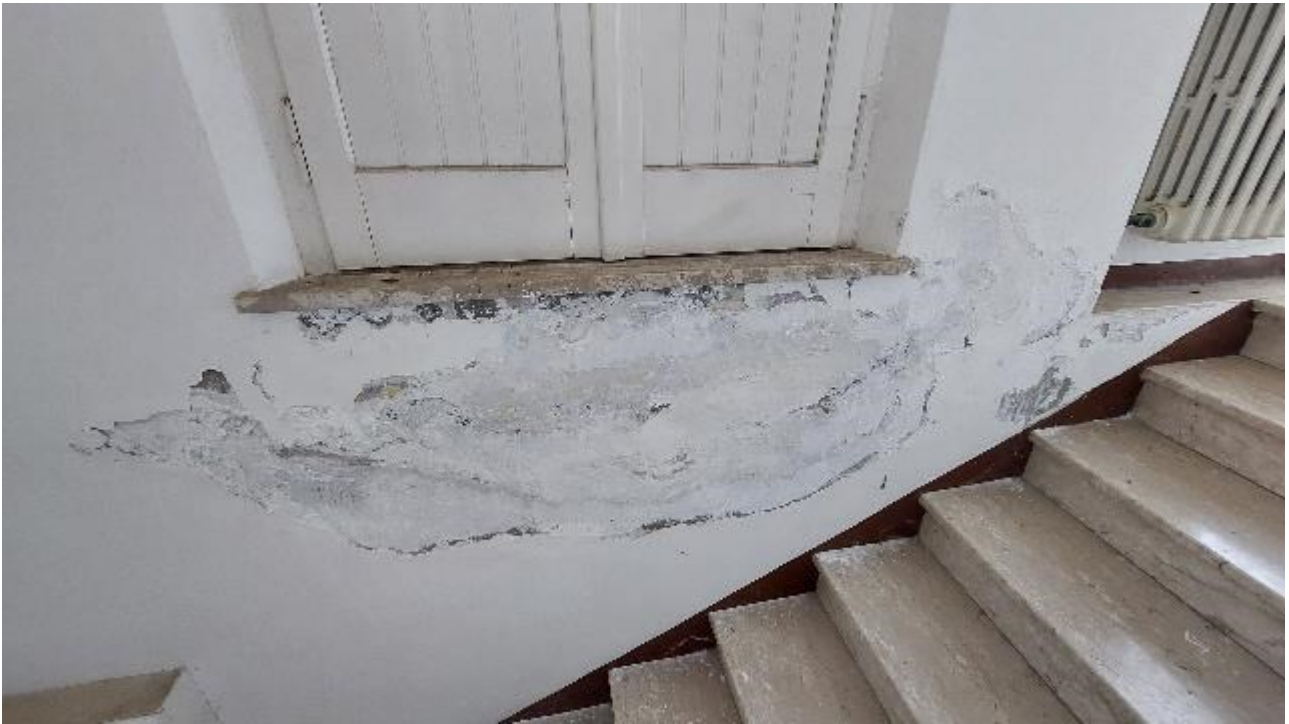
Infiltrazioni su parete scala di accesso
