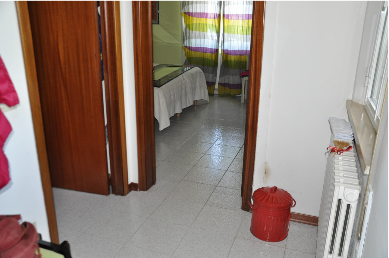
Foto 07 – Particolare di lesione sul pavimento rilevata il 31/05/2024
