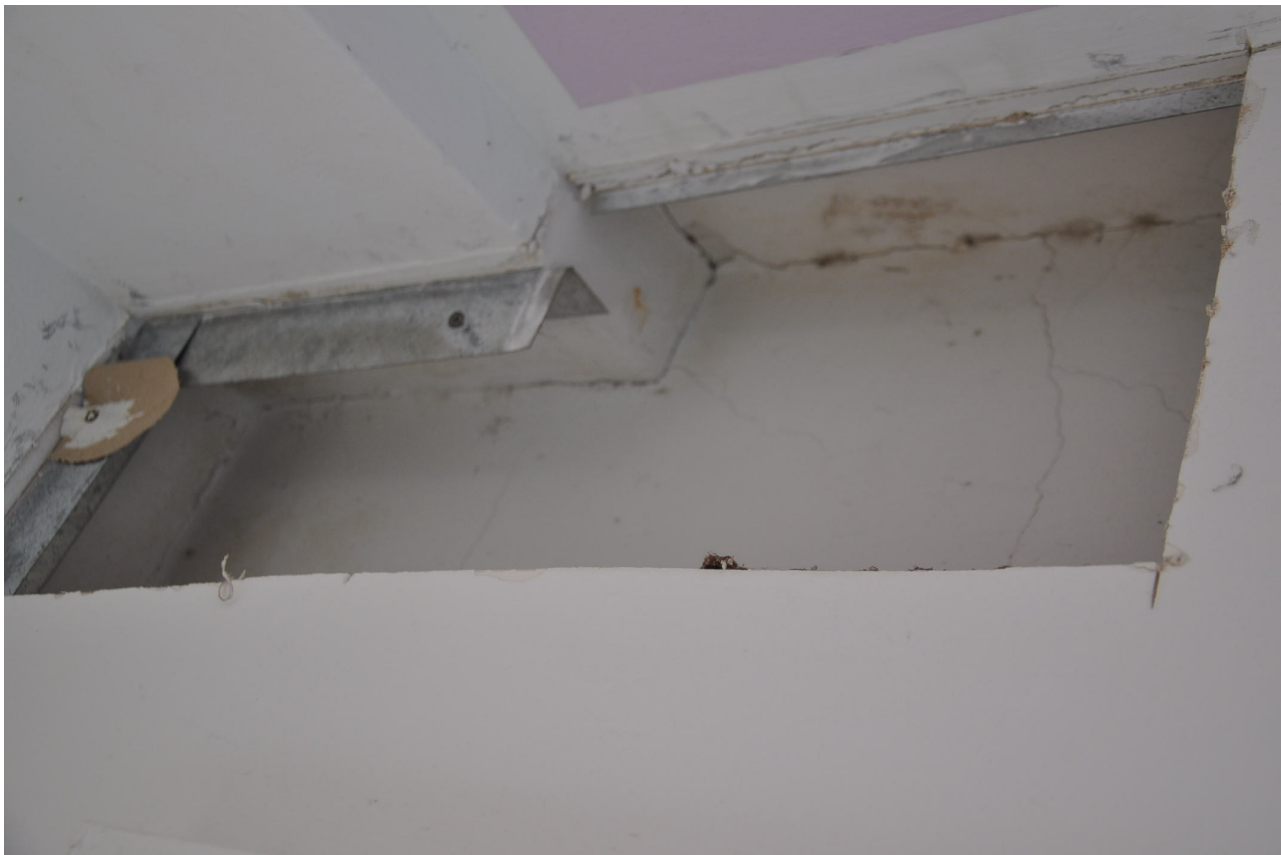
Foto 03 – Crepe da distacco submillimetriche tra muratura e telaio in cls armato
