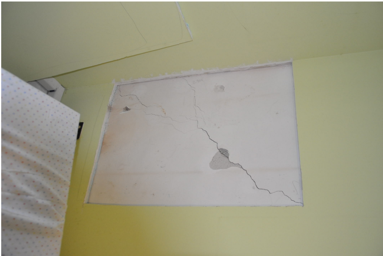
Foto 05 – Particolare di lesione millimetrica passante (presente anche su lato esterno fabbricato)
