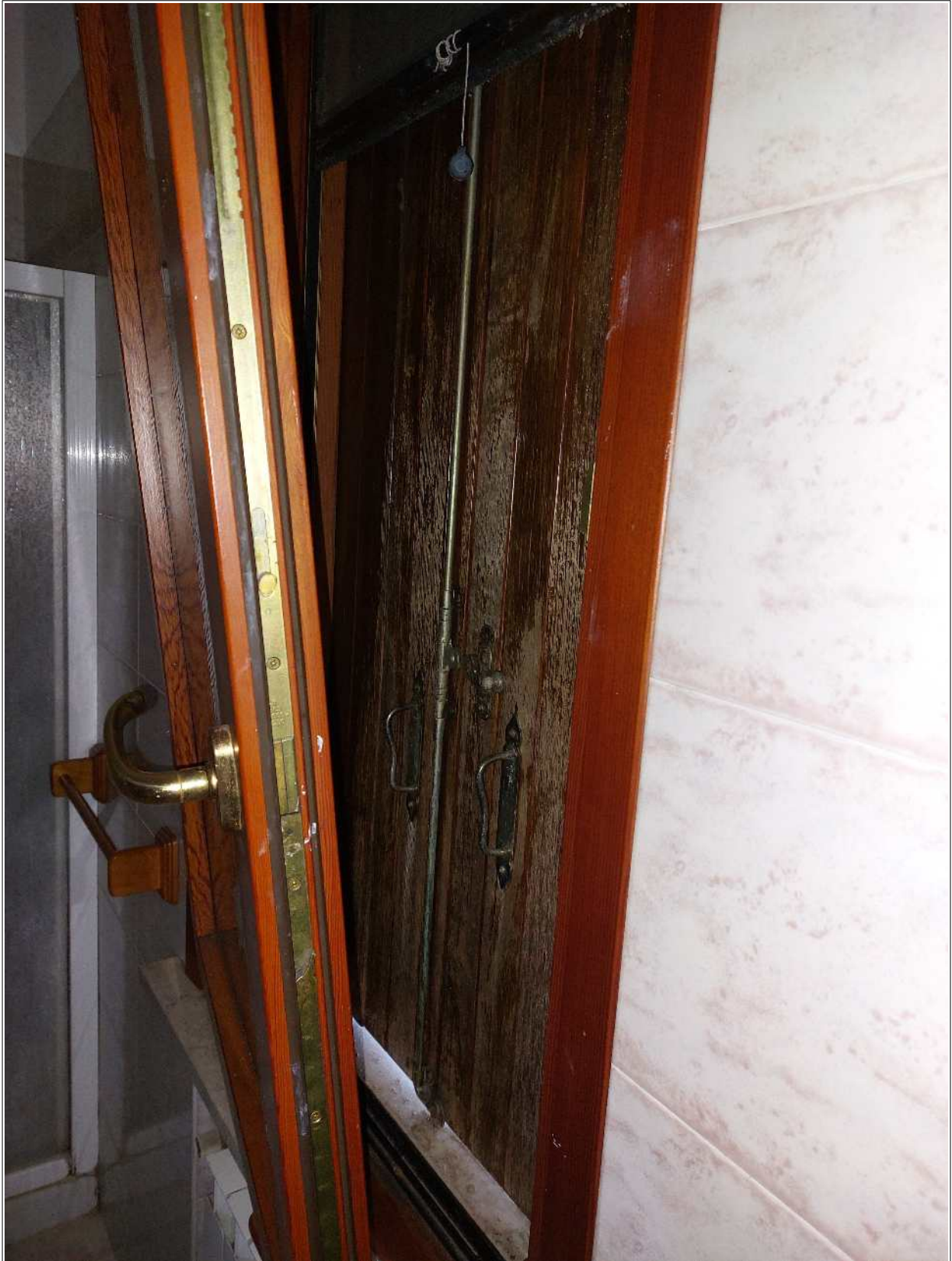
Foto n° 21 – 07/10/2023 - Comune di Sesto al Reghena, foglio 27, part.266, sub.1 – Particolare degli infissi.
