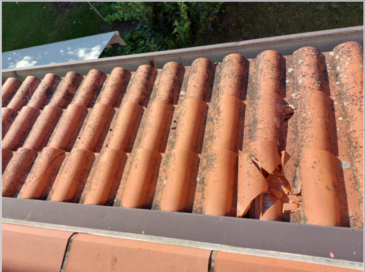
Foto n° 18 – 07/10/2023 - Comune di Sesto al Reghena, foglio 27, part.266, sub.1 – Particolare dei coppi danneggiati.
