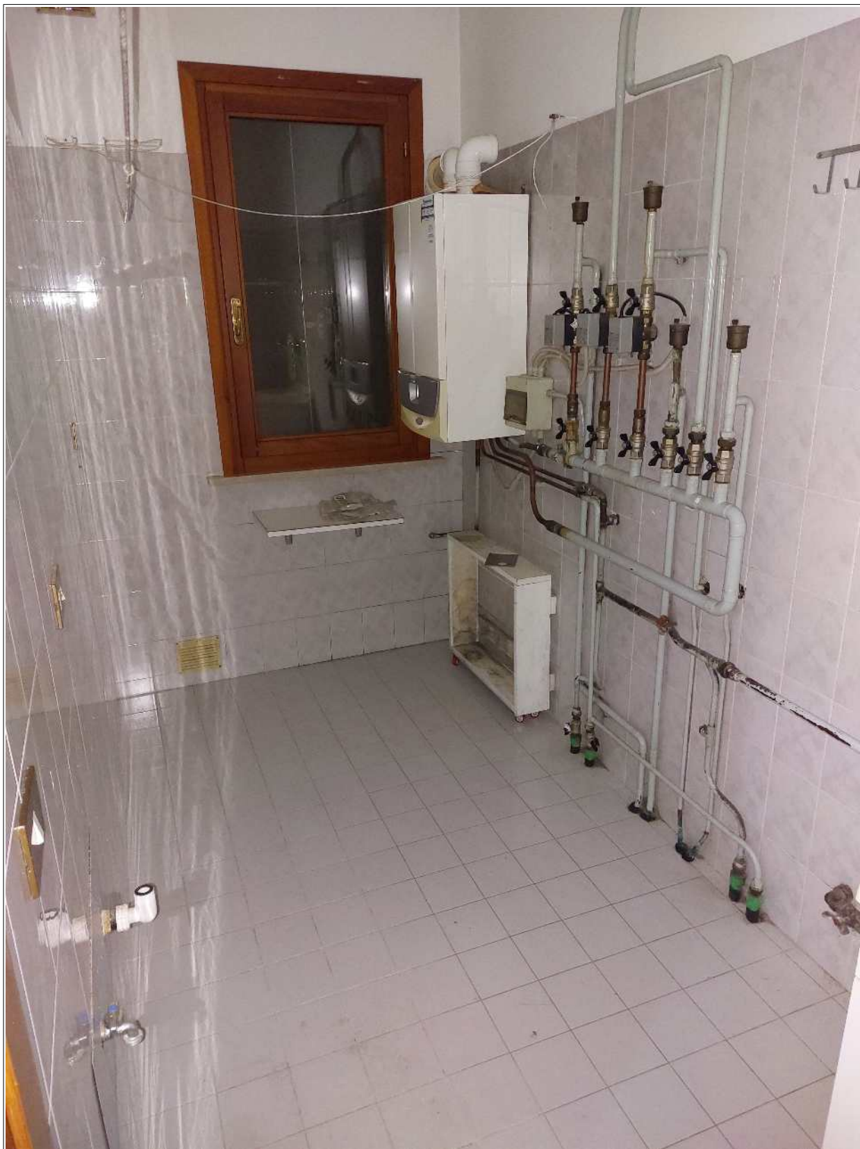
Foto n° 8 – 07/10/2023 - Comune di Sesto al Reghena, foglio 27, part.266, sub.1 – Centrale termica.
