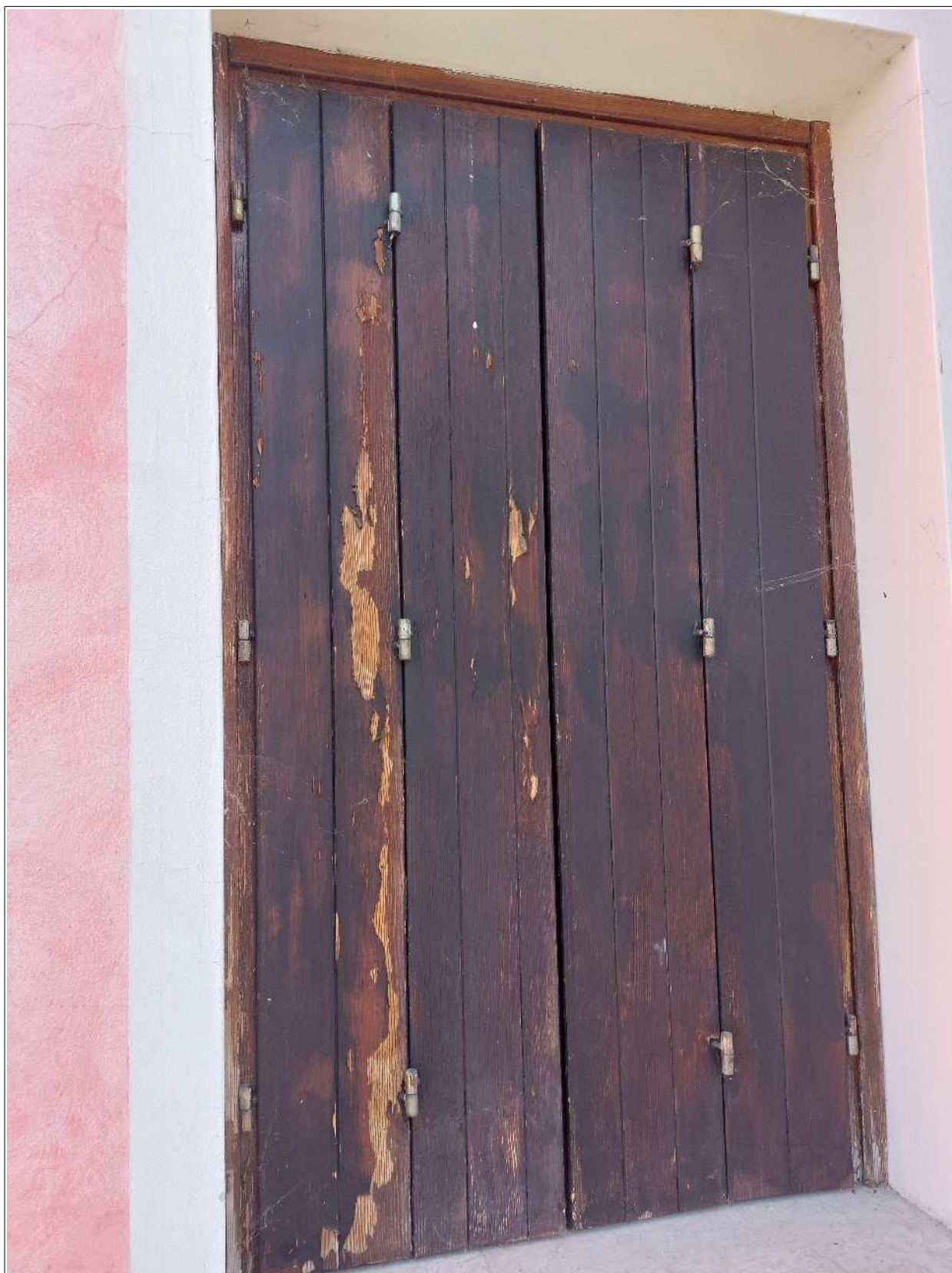
Foto n° 19 – 07/10/2023 - Comune di Sesto al Reghena, foglio 27, part.266, sub.1 – Particolare degli infissi.
