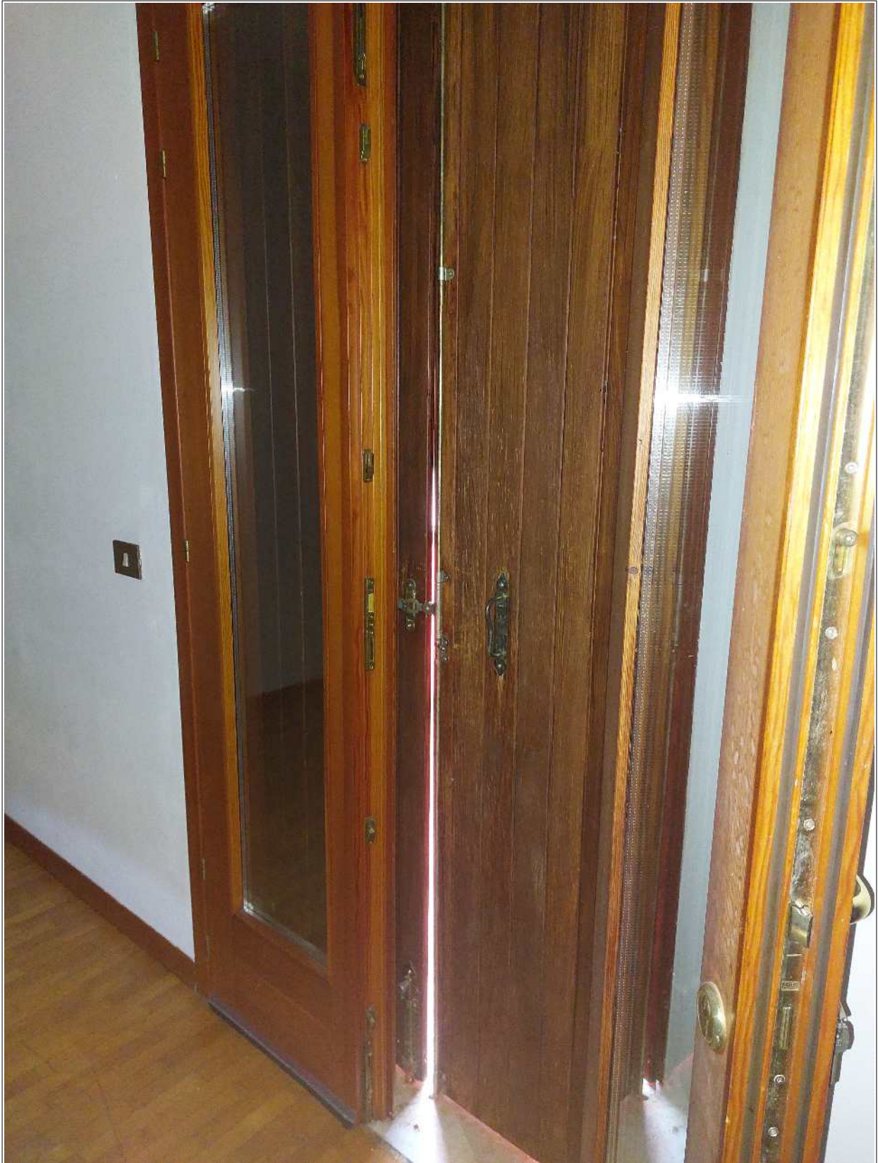
Foto n° 20 – 07/10/2023 - Comune di Sesto al Reghena, foglio 27, part.266, sub.1 – Particolare degli infissi.
