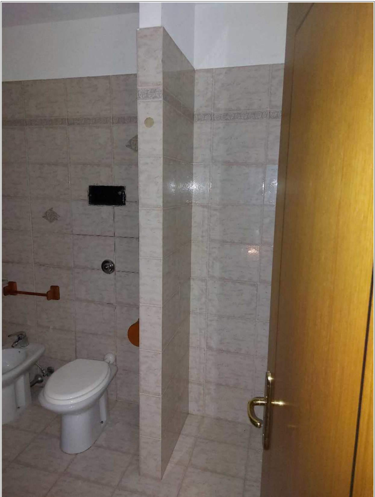
Foto n° 13 – 07/10/2023 - Comune di Sesto al Reghena, foglio 27, part.266, sub.1 – Bagno al P1.
