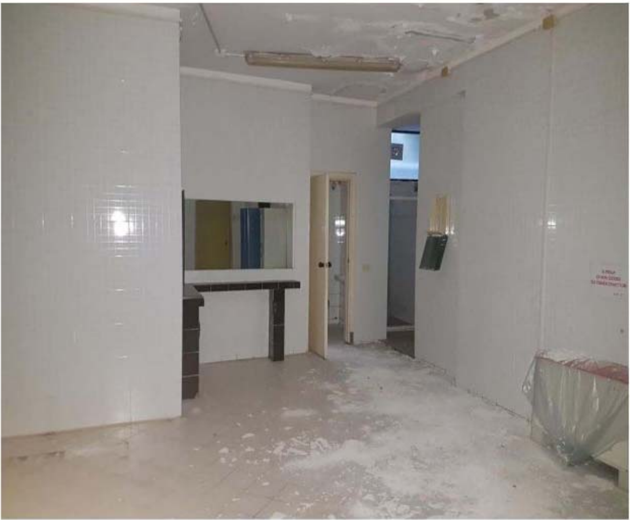
Infiltrazioni locali servizi
