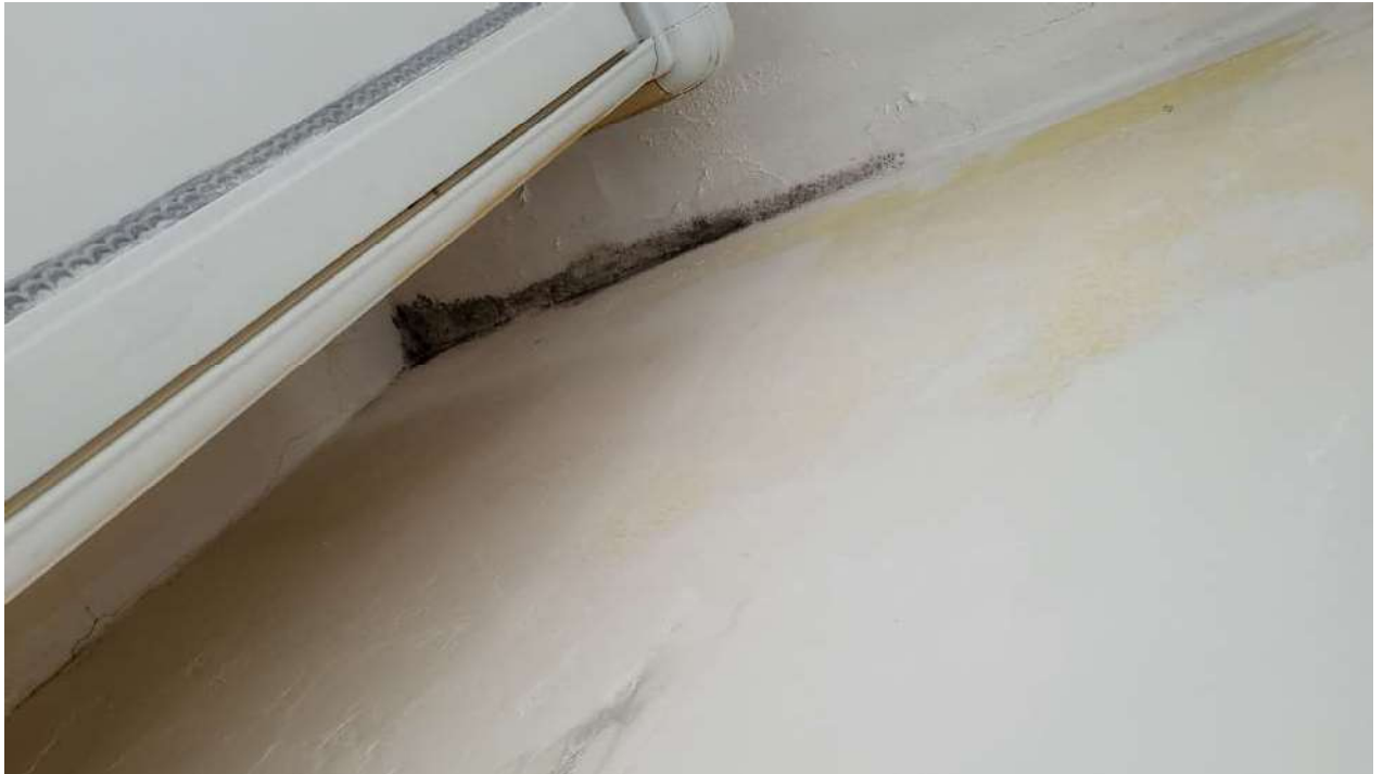
Dettagli – Muffa ed esfoliazione della pittura nella camera da letto matrimoniale
