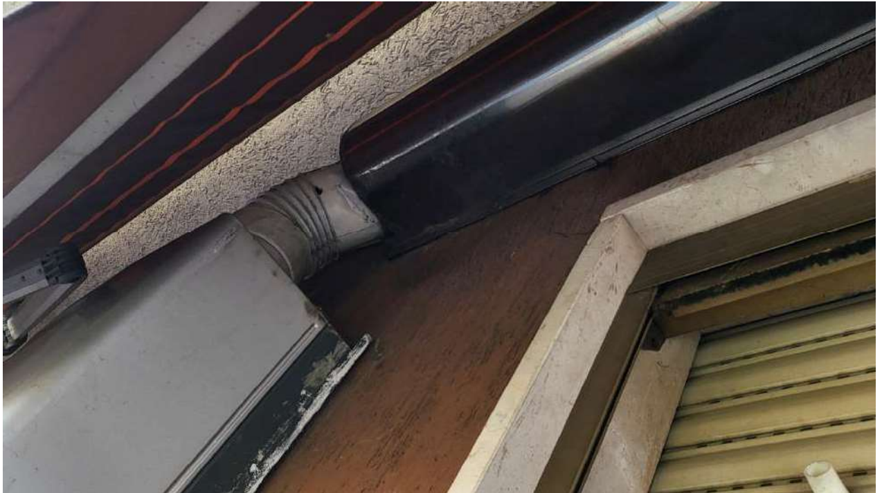
Dettagli – Canna fumaria della caldaia murale autonoma a gas metano
