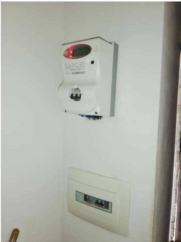
15) Particolari: contatore e quadro elettrico
