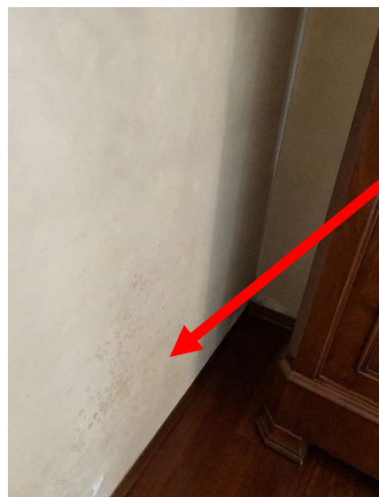
particolare tracce di muffa di lieve entità in una parete del pranzo/soggiorno
