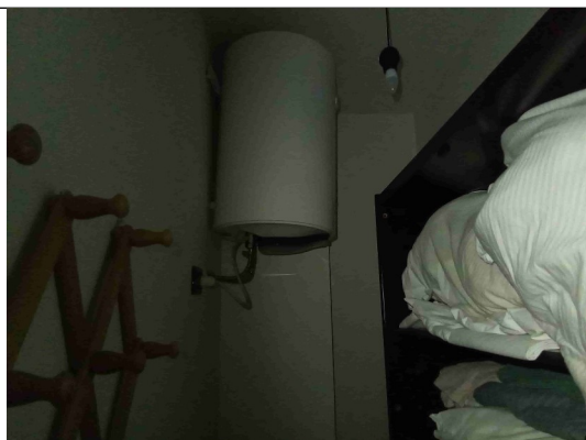
Veduta ripostiglio con boiler
