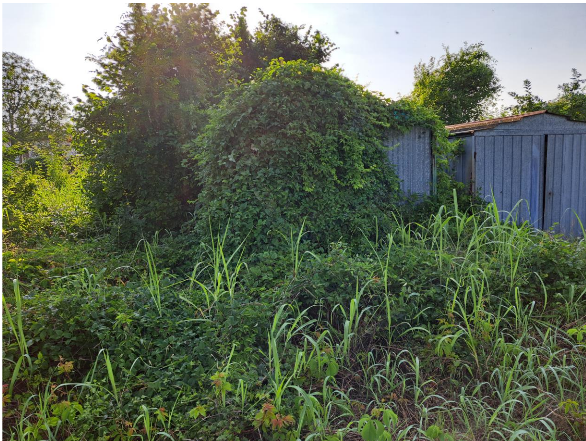
Foto n° 10 – Lotto 2 - 17/07/2023 – Comune di Pinzano al Tagliamento (PN) – Località Valeriano - Foglio 12 m.le 2032 – Particolare dei fabbricati abusivi in lamiera presenti in posizione sud ovest.
