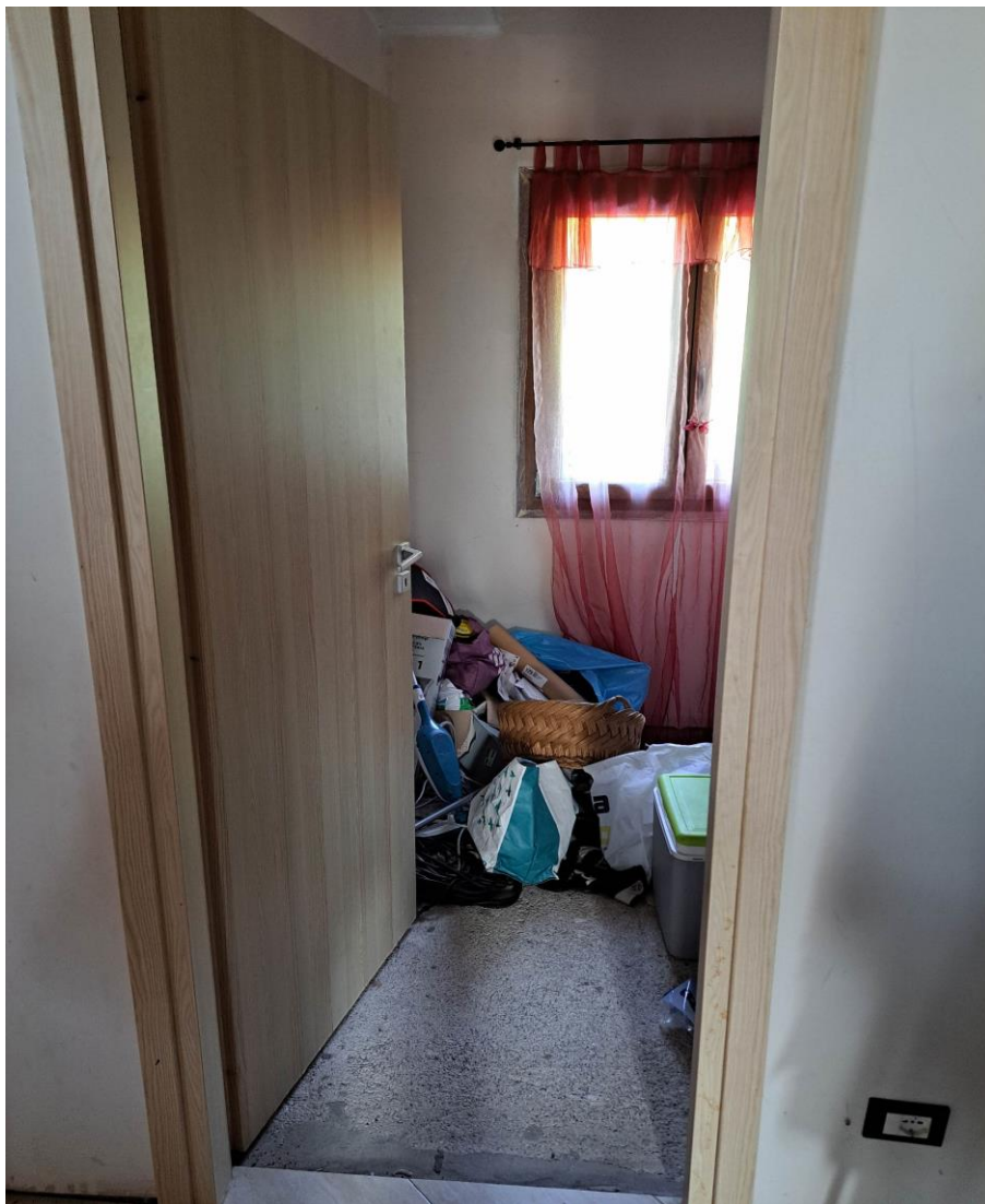
Foto n° 15 Lotto 2 - 17/07/2023 - Comune di Pinzano al Tagliamento (PN) - Località Valeriano - Foglio 12 m.le 2033 sub 5 - Ripostiglio al piano terra; in secondo piano le scale che conducono al piano interrato.
