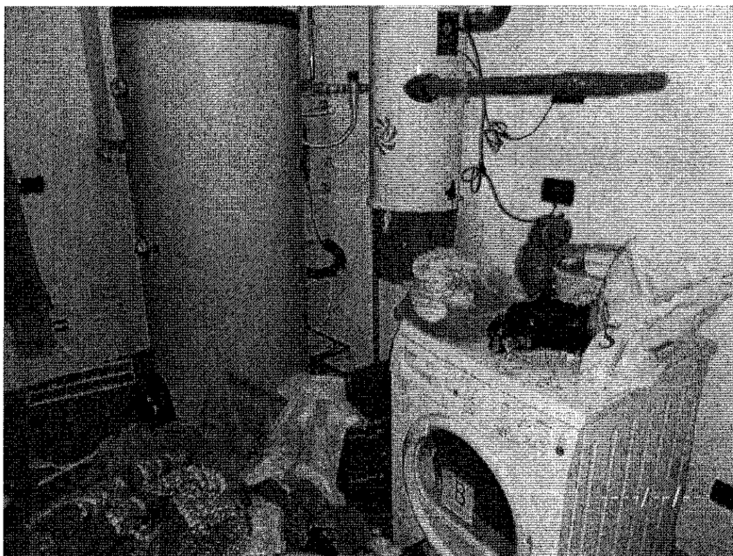
Foto n. 14: Locale tecnico - Piano Terra.
