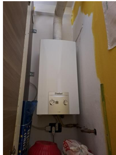
38. Caldaia in cucina
