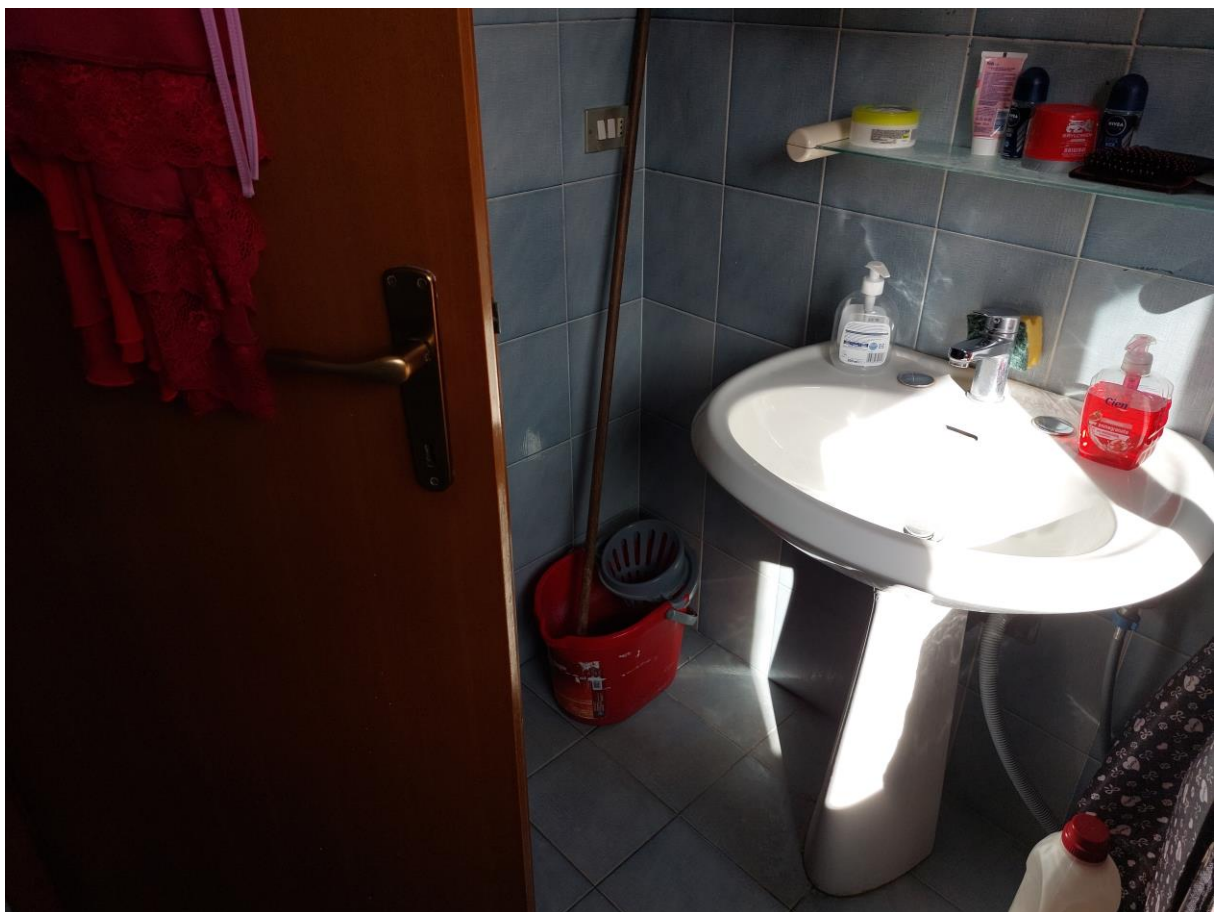
Foto n° 26 - Lotto 1 - 22/08/2022 - Comune di Pordenone - Foglio 11 - mappale 417 sub 3, appartamento A/4, primo piano - Vista interna dell'accesso al vano uso bagno.
