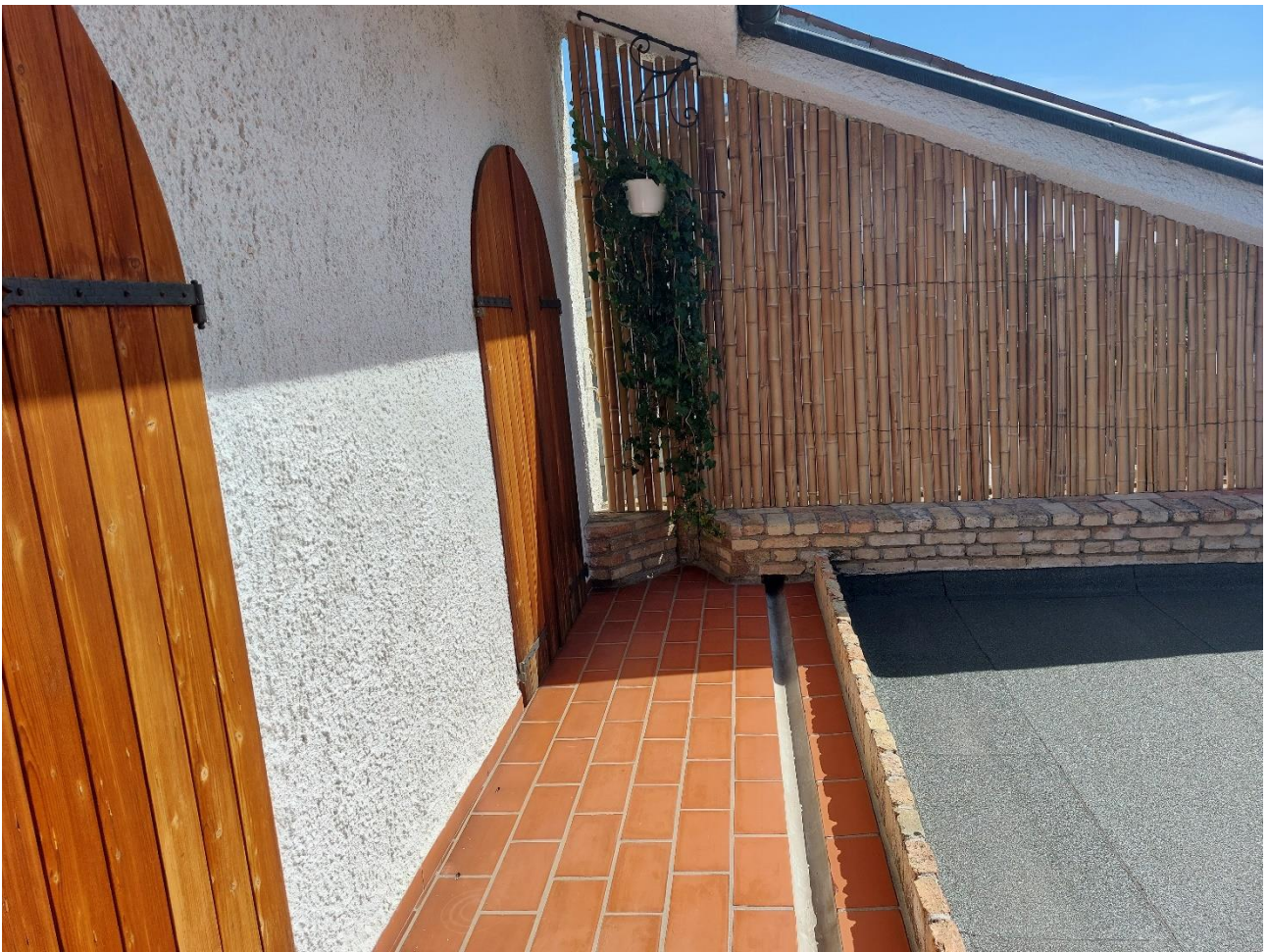
Foto n° 49 – Lotto 2 – 22/08/2022 - Comune di Porcia – Foglio 13 – mappale 700 sub 1 – Veduta di parte del terrazzo esterno al primo piano, nella parte posta a nord-est.
