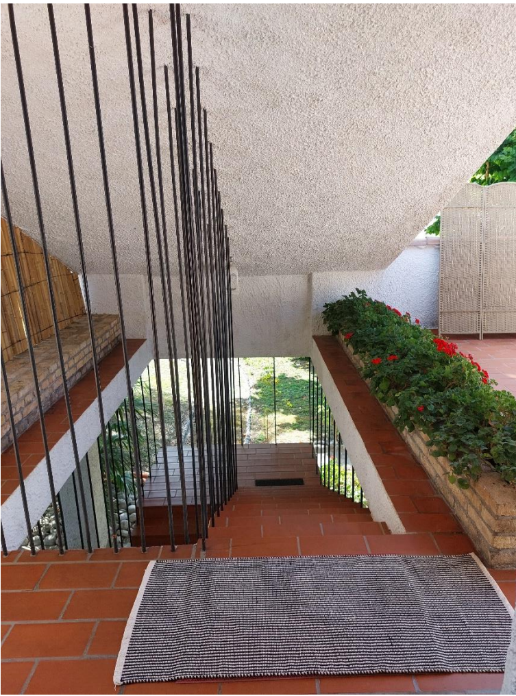
Foto n° 45 – Lotto 2 – 22/08/2022 - Comune di Porcia – Foglio 13 – mappale 700 sub 1 – Veduta, dal primo piano, della scala di cui alla foto precedente.
