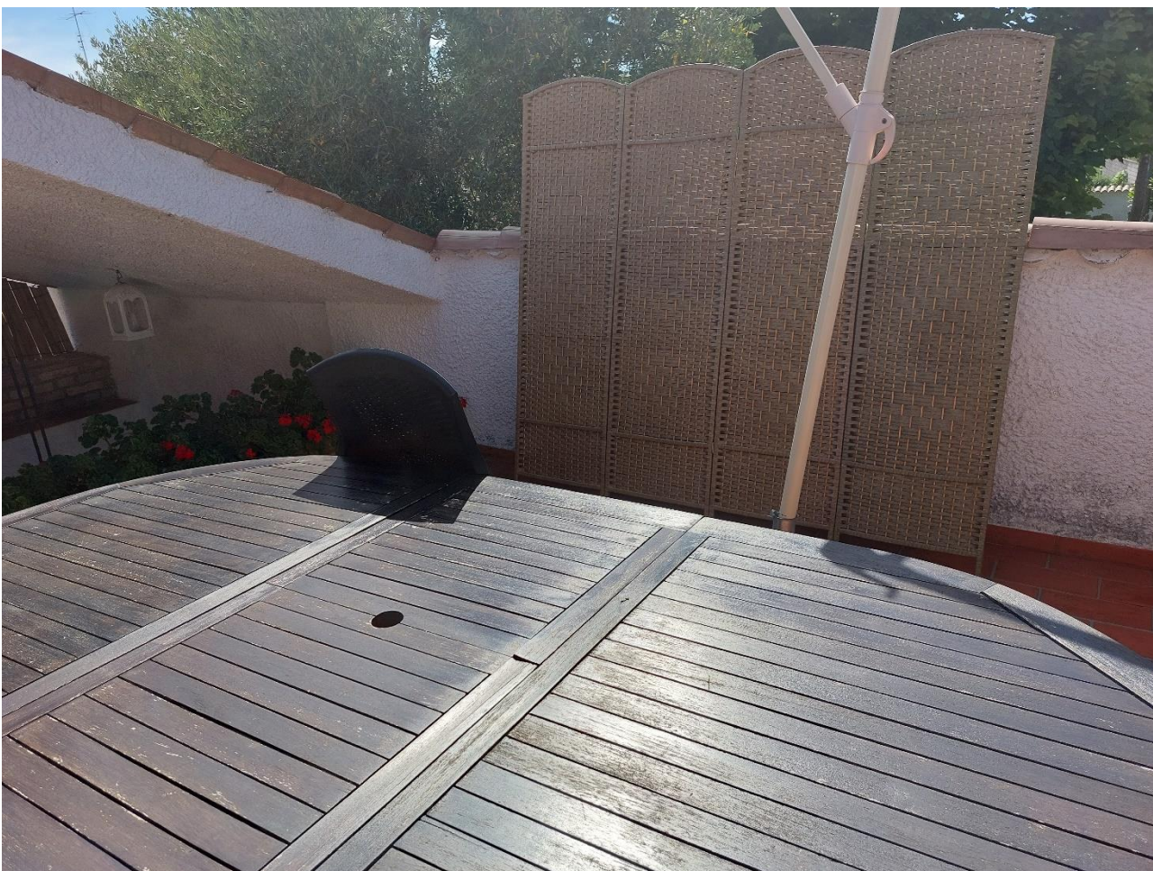
Foto n° 48 – Lotto 2 – 22/08/2022 - Comune di Porcia – Foglio 13 – mappale 700 sub 1 – Particolare della stessa porzione del terrazzo esterno di cui alla foto precedente, da posizione opposta.
