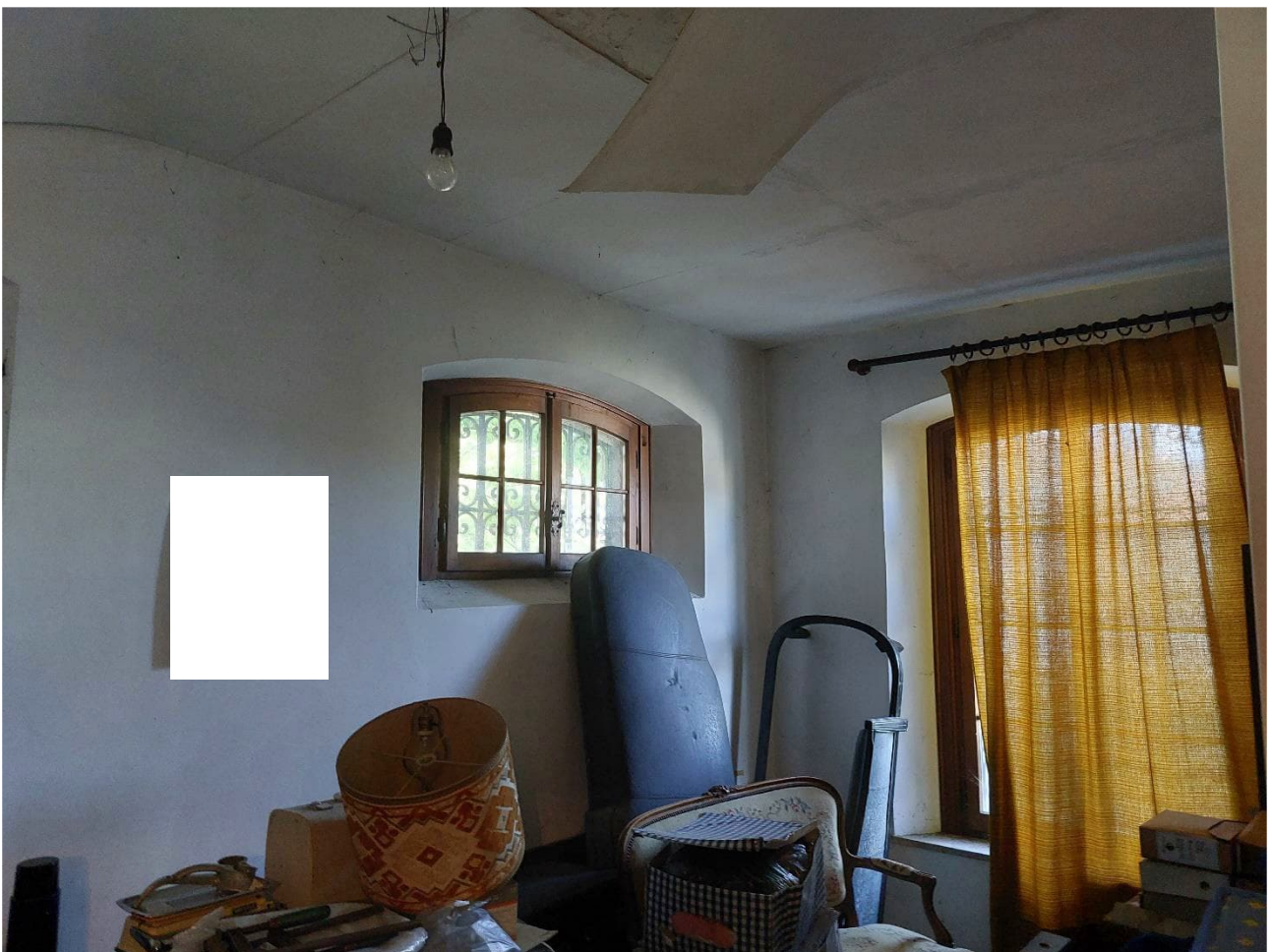
Foto n° 38 – Lotto 2 – 22/08/2022 - Comune di Porcia – Foglio 13 – mappale 700 sub 2 – Particolare della parte sud-ovest del terzo ufficio di cui alla foto precedente.
