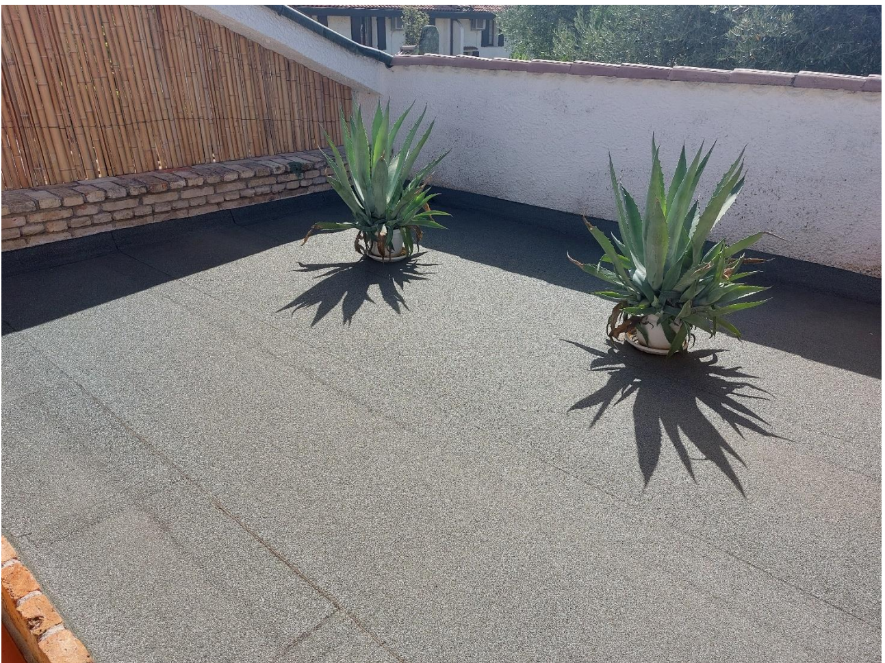
Foto n° 50 – Lotto 2 – 22/08/2022 - Comune di Porcia – Foglio 13 – mappale 700 sub 1 – Particolare della parte di terrazzo di cui alla foto precedente, nella parte posta a sud-est.
