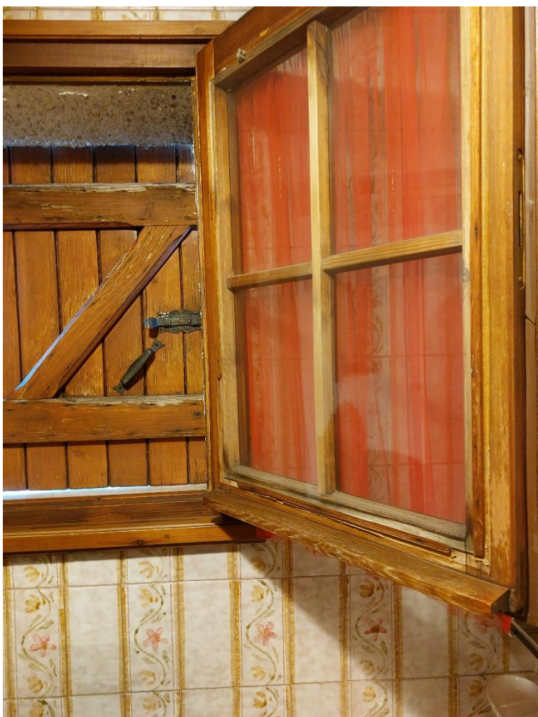
Foto n° 68 - Lotto 2 - 22/08/2022 - Comune di Porcia - Foglio 13 - mappale 700 sub 1 - Particolare della finestra presente nel bagno di cui alla foto precedente.
