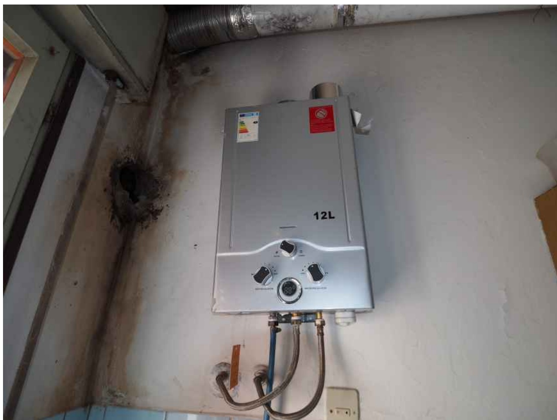
Azzano Decimo, via Pustotti n. 8 – Le due caldaie per la produzione dell'acqua calda Sanitaria.
