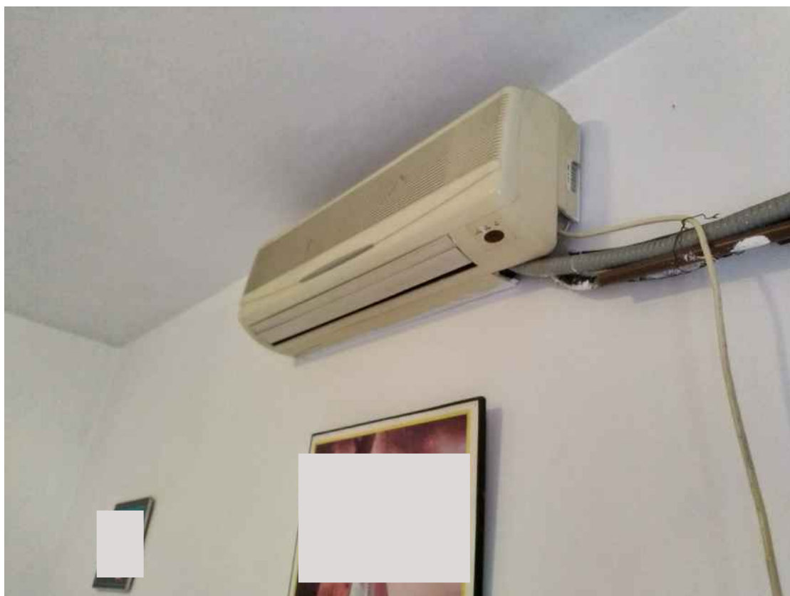
Azzano Decimo, via Pustotti n. 8 – Particolare dell'impianto di climatizzazione.
