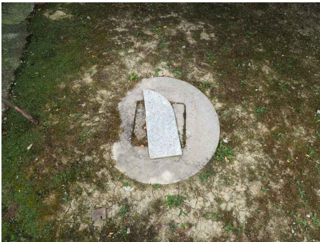
Azzano Decimo, via Pustotti n. 8 – Sopra il pozzetto dove è ubicato il contatore dell'acqua, sotto il pozzetto relativo all'impianto fognario .
