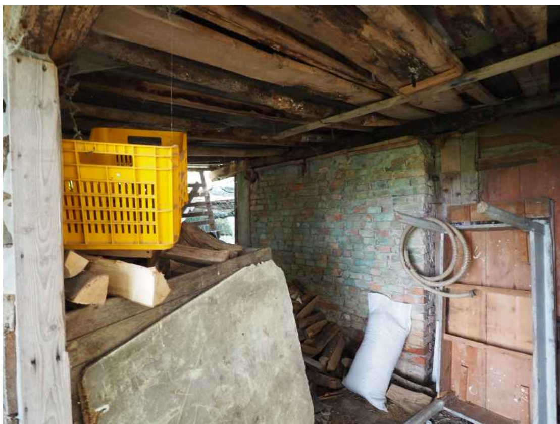
Azzano Decimo, via Pustotti n. 8 – La legnaia esterna costruita abusivamente.
