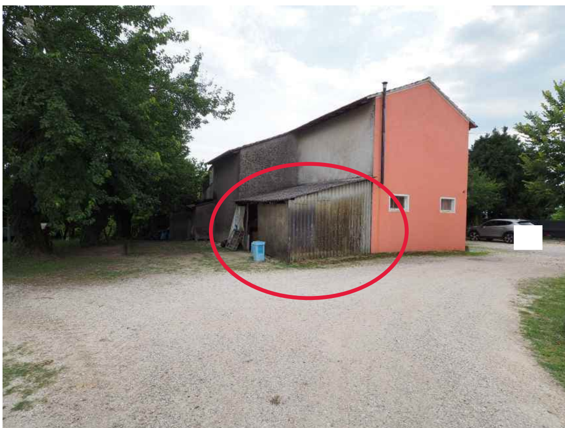
Azzano Decimo, via Pustotti n. 8 – I prospetti sud, nord ed est del fabbricato rurale di pertinenza, cerchiato in rosso la parte abusiva.
