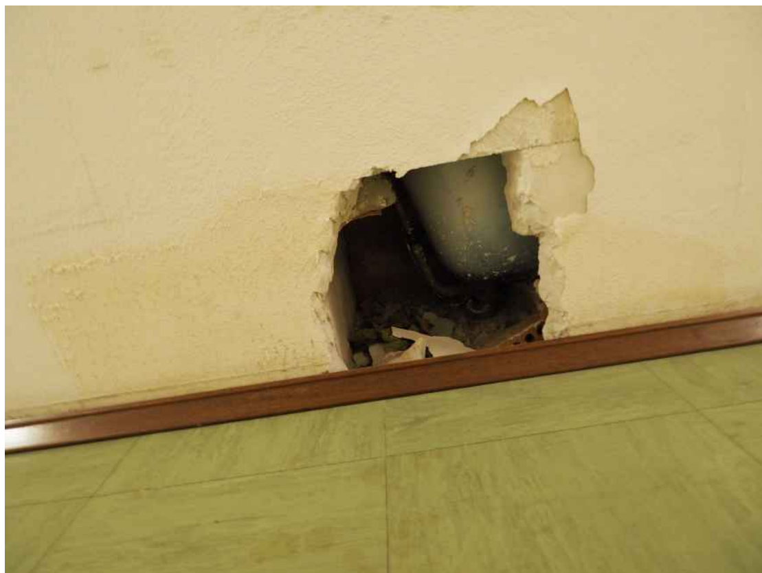
Sacile, viale Repubblica n°23 – Particolari dei danni dovuti ad una presunta perdita dalla vasca da bagno dell'appartamento ed il sondaggio effettuato dal condominio.
